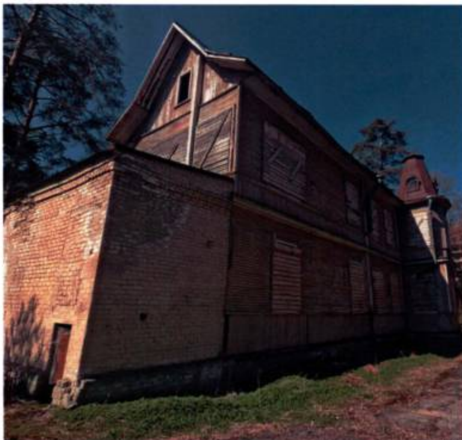
4. Северный фасад объекта культурного наследия (Фотография от 12.05.2025).
