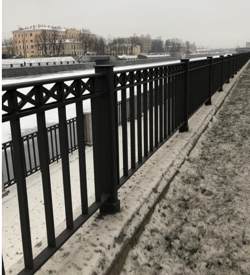
11. Объект культурного наследия регионального значения «Набережная Обводного канала» по адресу: от Шлиссельбургского моста до Московской ж. д. Участок от протоки Французского ковша до Атаманского моста, левый берег. Верхний уровень. Металлическое ограждение.
