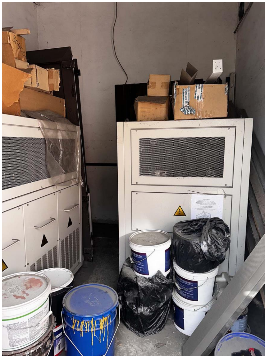
Фото 11. Помещение архива СПб ГУП «Горэлектротранс», расположенное в объекте культурного наследия регионального значения «Подстанция» (ул. Атаманская, д. 3/6 литера С). 1-ый этаж, техническое помещение в южной части дворовой одноэтажной пристройки здания. Фото с юга. Дата съемки: 01.06.2026 г. Автор съемки: Куваева Ю.П.
