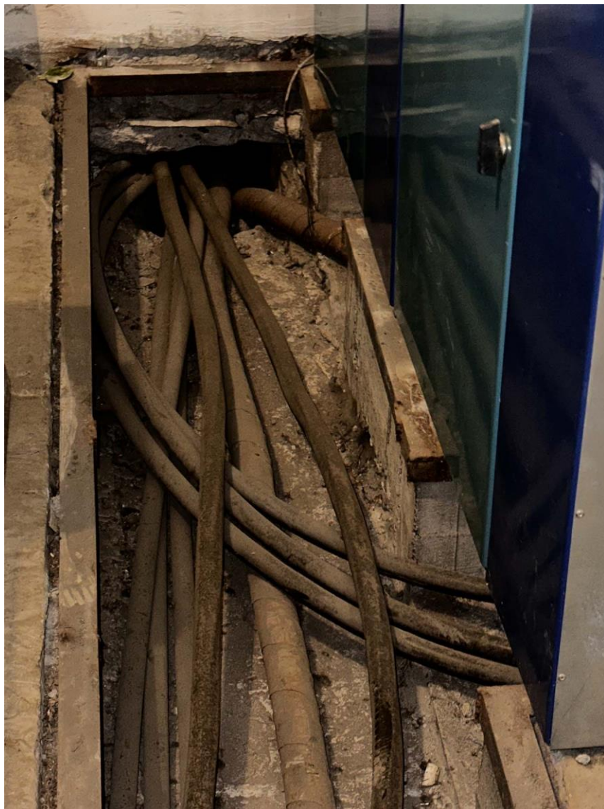
Фото 15. Помещение архива СПб ГУП «Горэлектротранс», расположенное в объекте культурного наследия регионального значения «Подстанция» (ул. Атаманская, д. 3/6 литера С). 1-ый этаж, техническое помещение в юго-восточной части здания. Прокладка электрокабеля. Фото с запада. Дата съемки: 01.06.2026 г. Автор съемки: Куваева Ю.П.
