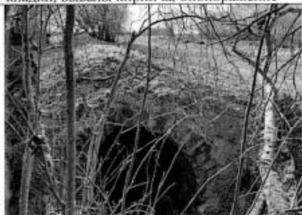
Фото 28. Вход в кирпичную галерею в месте разрушения
