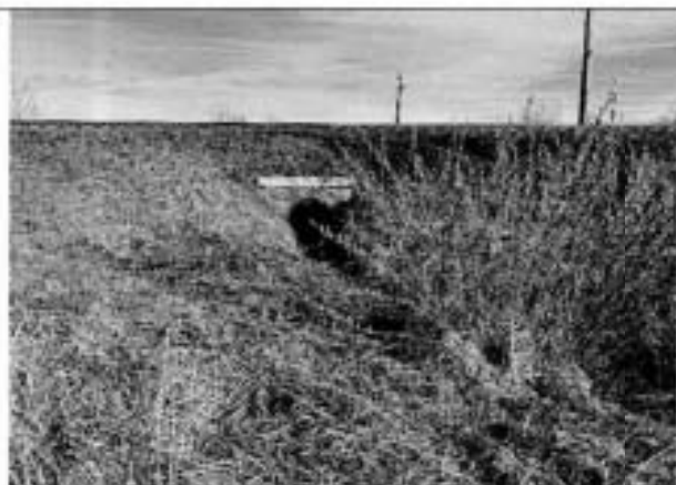
Фото 17. Труба под ж/д веткой на трассе водовода
