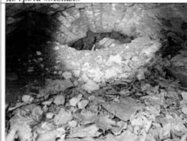
Фото 49. Кирпичный мост на Баурском канале – свод просел, проточность отсутствует
