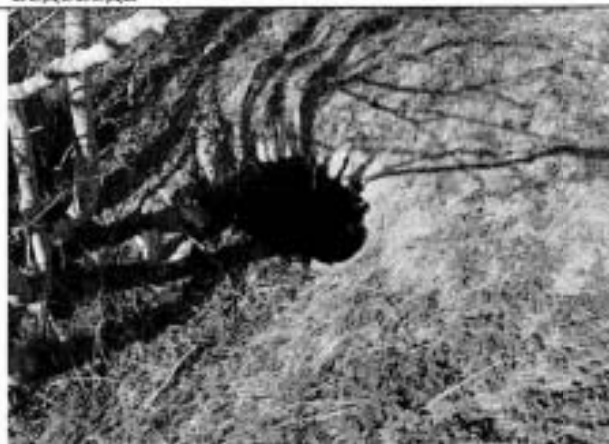
Фото 19. Вход в кирпичную галерею в месте разрушения
