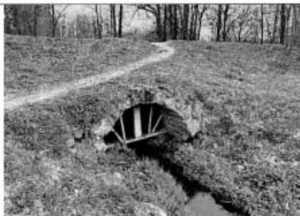
Фото 53. Каменный мост – акведук на Баурском канале. Разрушение облицовки фасада. Выполнены поддерживающие конструкции свода
