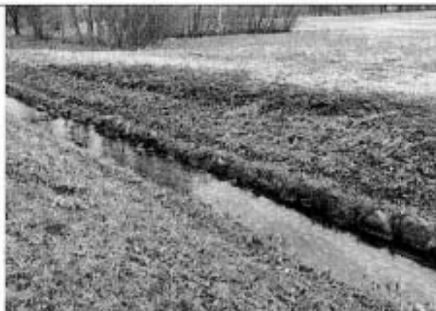
Фото 65. Мощение канала булыжным камнем имеет нарушения.
