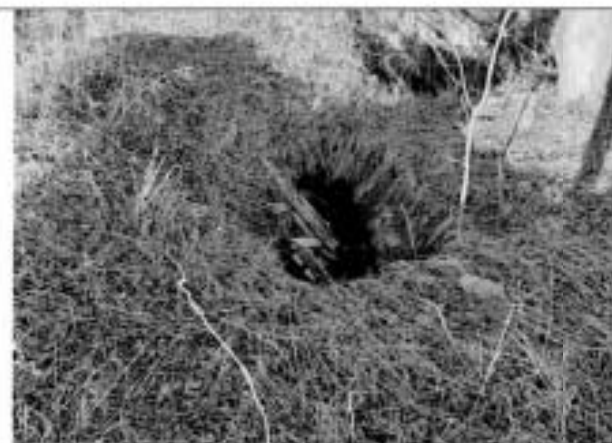
Фото 11. Провалы кирпичной галереи в Новокондакопшино
