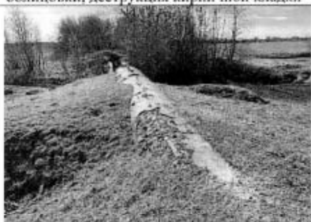
Фото 25. Подходный участок полуподземной галереи к акведуку. Нарушение защитного слоя, деструкция поверхности кирпича
