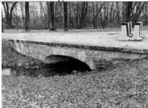
Фото 67. Мостик через канал на аллее. Известняковая облицовка верхового фасада. Имеется деструкция и трещины в камне
