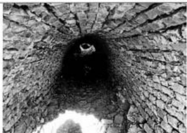
Фото 36. Вид кирпичного водовода изнутри. Утрата шовного раствора, вывалы кирпича, биопоражение
