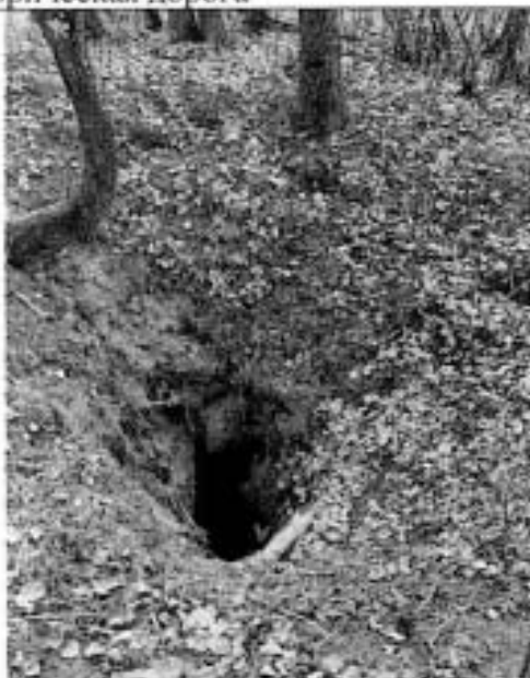
Фото 3. Колодец для обслуживания водовода на участке минной галереи
