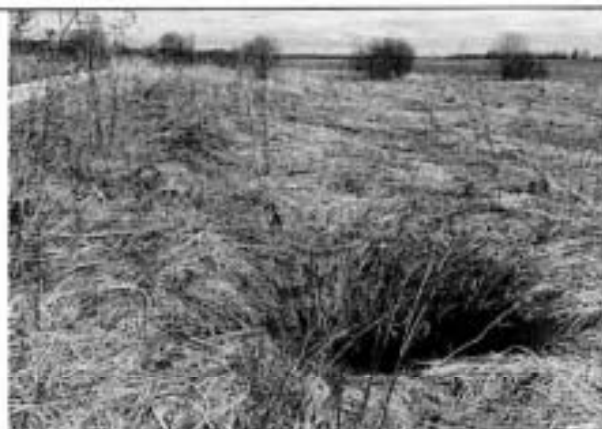
Фото 2. Воронка на месте колодца для обслуживания водовода
