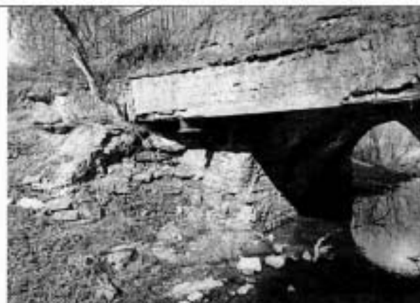
Фото 101. Павловск, ул. Правды. Водопроводный мост, разрушение южного фасада
