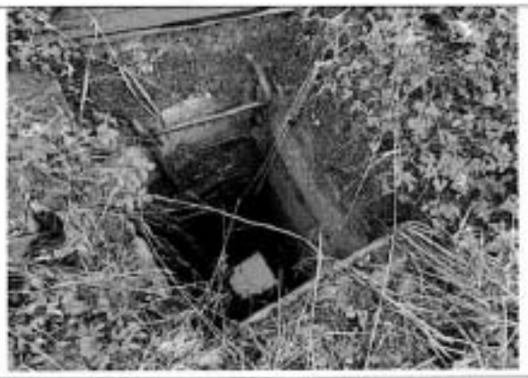
Фото 76. Колодец на ж/б трубопроводе между Отдельным парком и Тярлевским ручьем с востока от Фильтровского шоссе
