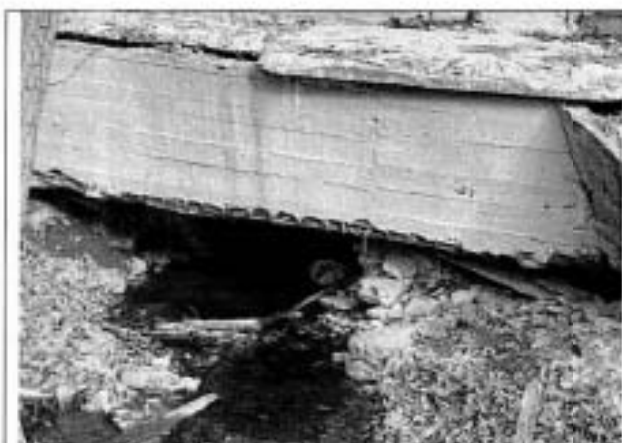
Фото 107. Павловск, ул. Красного курсанта. Мост на ручье. Разрушение западного фасада, обетонированные конструкции
