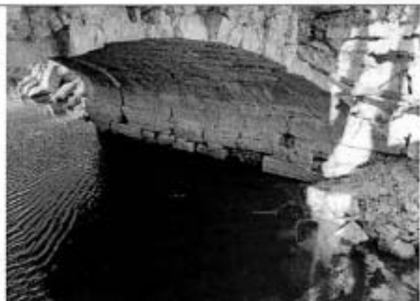
Фото 24. Акведук через р. Кузьминку. Дефекты свода моста, вывалы камня
