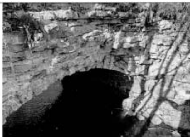
Фото 23. Акведук через р. Кузьминку, восточный фасад. Утрата известняковой облицовки, деструкция кирпичной кладки
