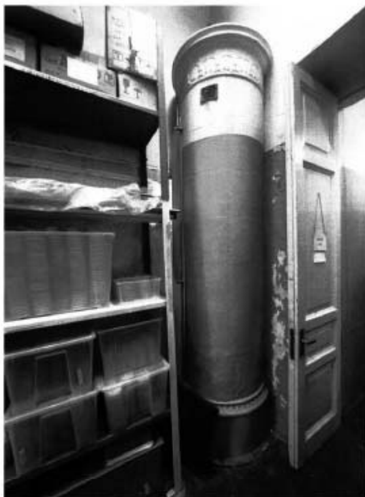
4. Печь в помещениях 3 этажа здания (27.09.2024)
