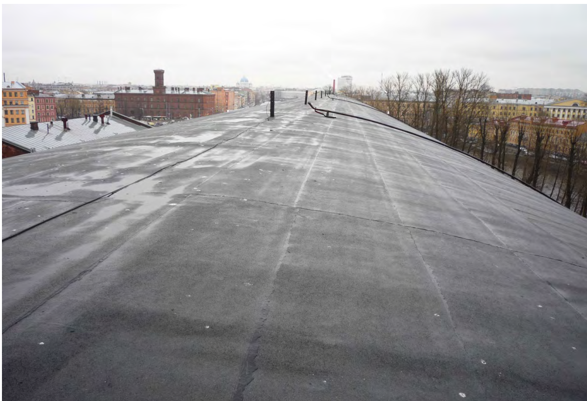
15. Выявленный объект культурного наследия «Разбивочный плаз». Кровля. Вид на восток. Съёмка 23 марта 2021 г.
