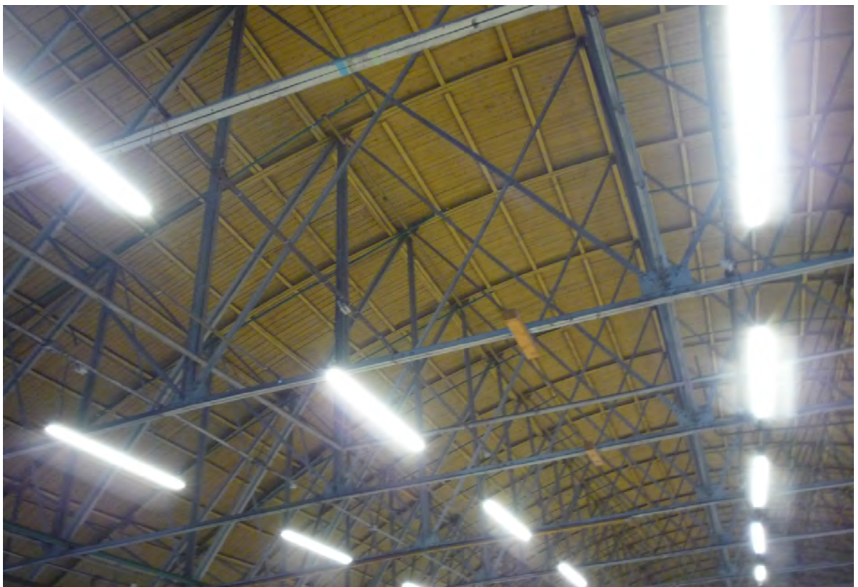
28. Выявленный объект культурного наследия «Разбивочный плаз». Вид цеха на 4 этаже (на запад). Конструкции ферм. Съёмка 23 марта 2021 г.
