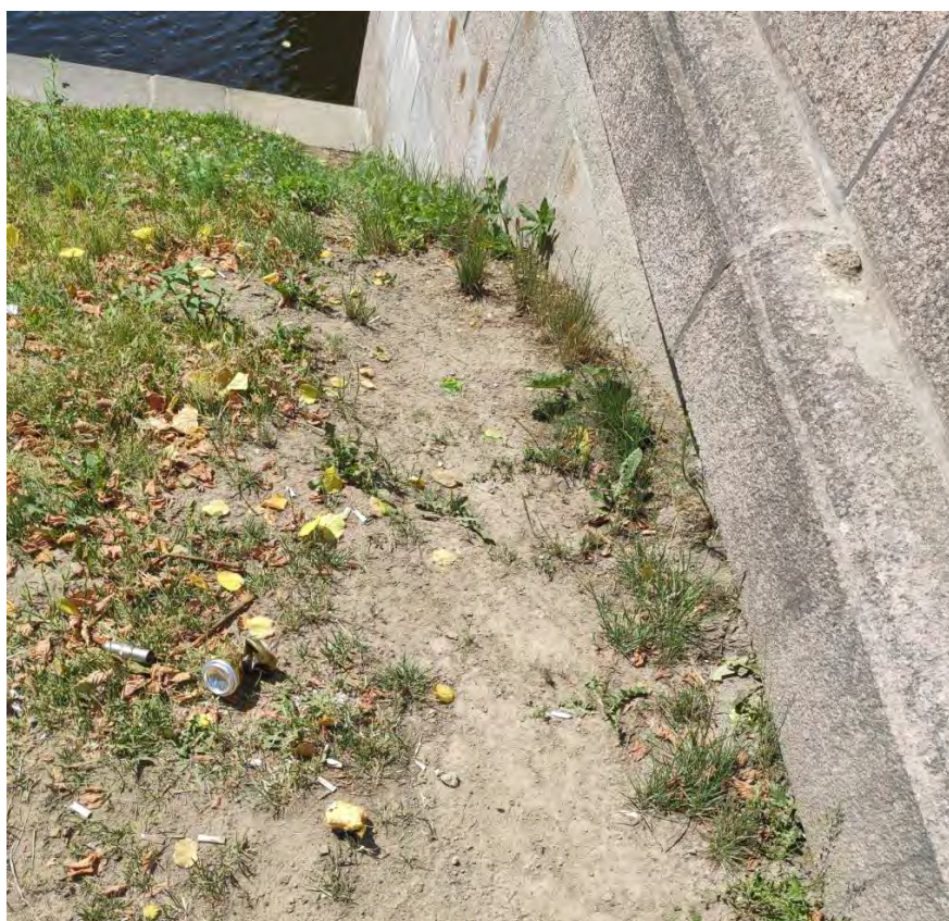
Фото 8. Вид на участок газона непосредственно примыкающего ко 2-му Садовому мосту, вдоль моста устроен стихийный спуск к воде, газон вытоптан. Фото – Давыдова Н.А., 22.06.2020.
