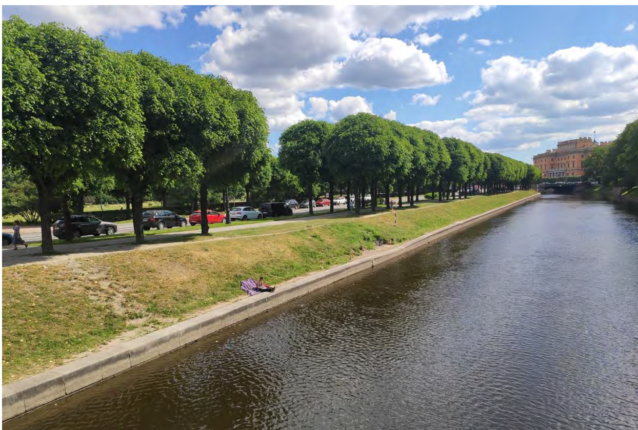
Фото 6. Вид на набережную реки Мойки со 2-го Садового моста, видны протоптанные участки на откосе, желающими отдохнуть у воды, на дальнем плане виден размыв откоса в месте протечки канализационной сети. Фото – Давыдова Н.А., 22.06.2020.
