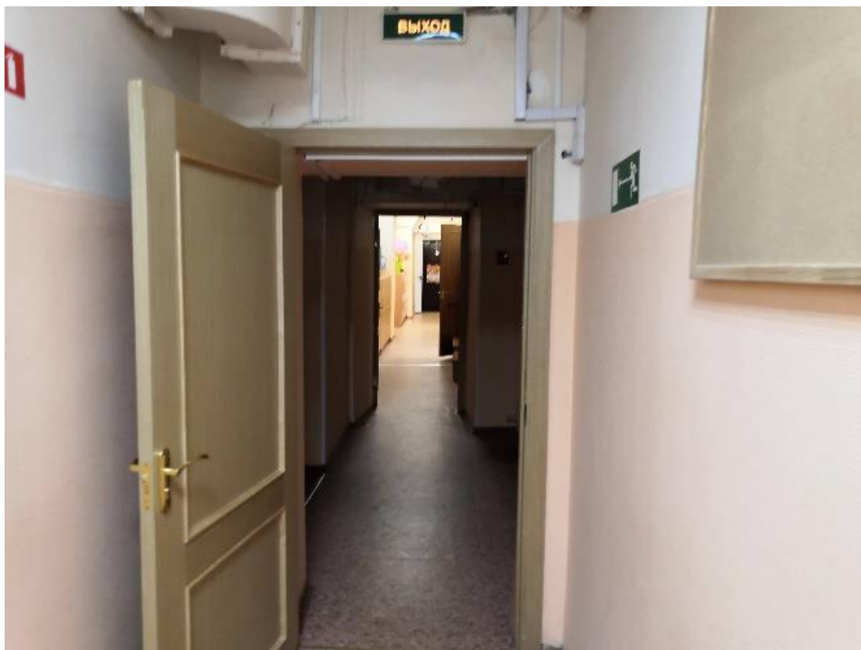
13. Объект культурного наследия федерального значения «Дом Демидова П.Г.», входящий в состав объекта культурного наследия федерального значения «Усадьба Демидовых», по адресу: г. Санкт-Петербург, пер. Гривцова, д. 5, лит. А (Гривцова пер., 1). Помещение 8-Н. Общий вид коридора.
