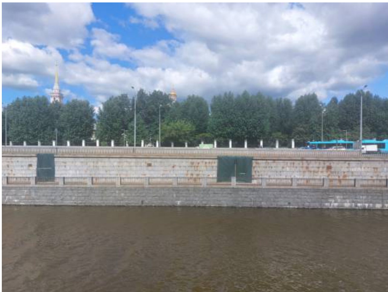
3. Набережная Обводного канала, правый берег. Нижний ярус с облицовкой более темного цвета - объект культурного наследия регионального значения "Набережная Обводного канала". Высолы на облицовке
