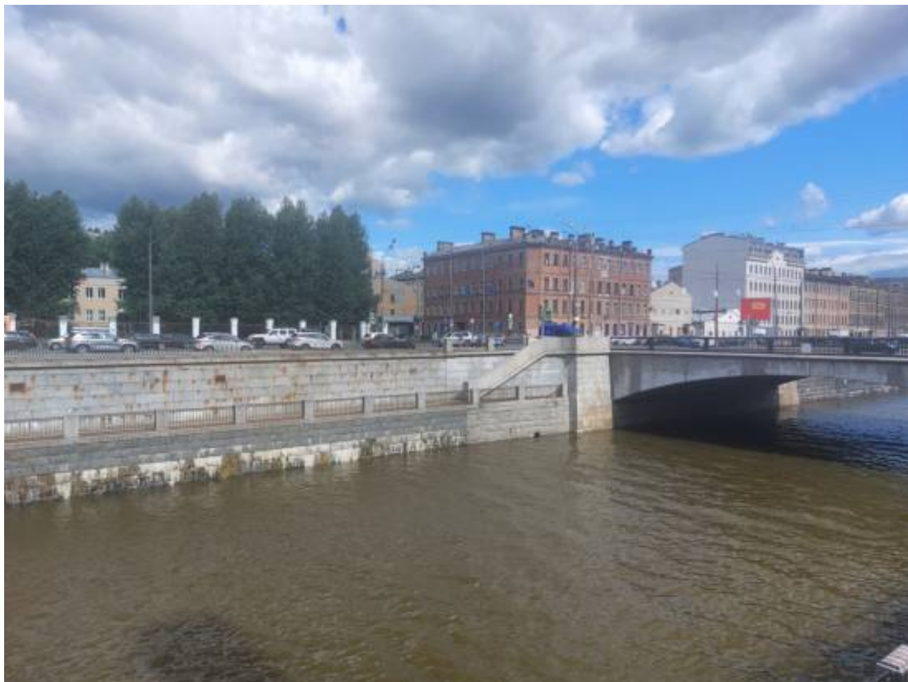
5. Набережная Обводного канала, правый берег. Нижний ярус с облицовкой более темного цвета - объект культурного наследия регионального значения "Набережная Обводного канала". Высолы на облицовке
