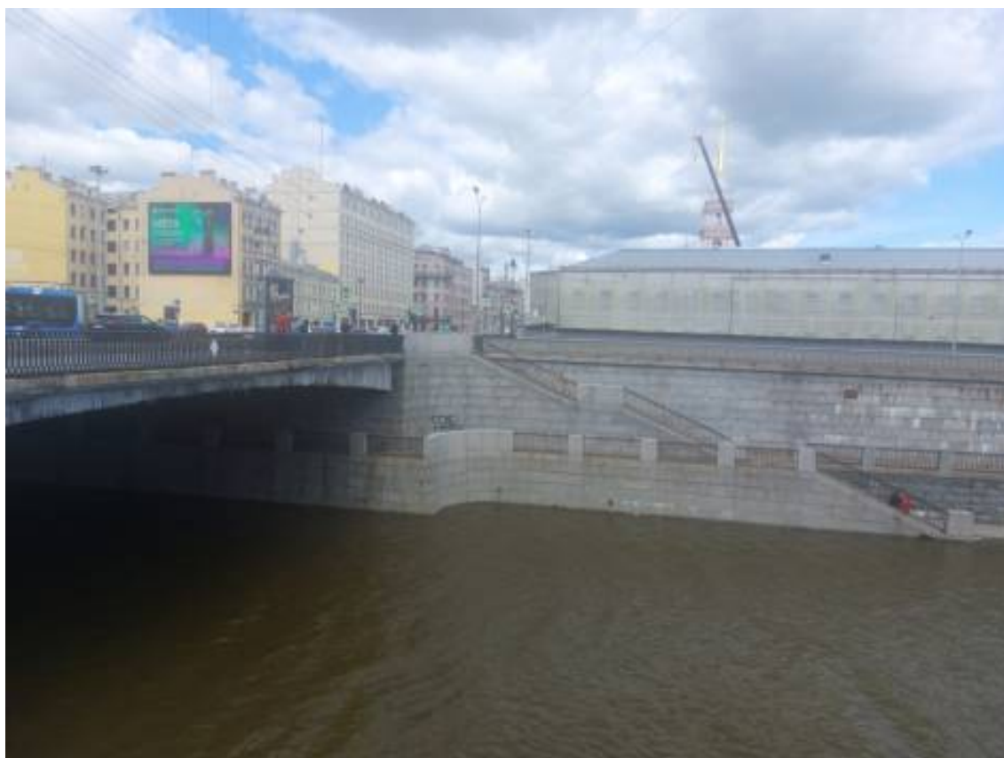
1. Набережная Обводного канала выше Ново-Каменного моста, правый берег. Нижний ярус справа с облицовкой более темного цвета - объект культурного наследия регионального значения "Набережная Обводного канала". Высолы на облицовке
