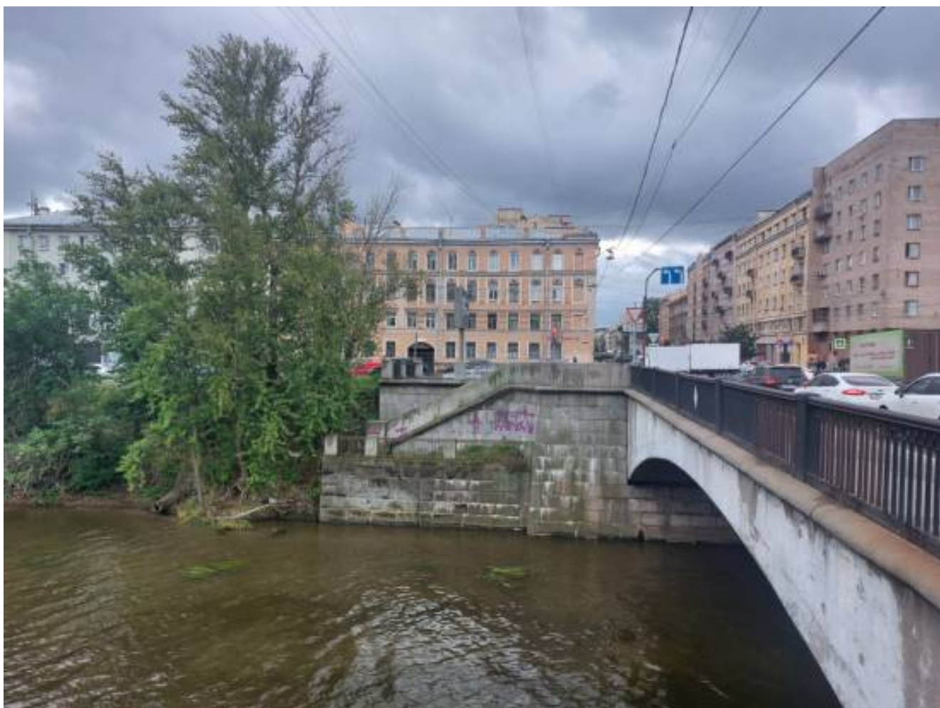
7. Набережная Обводного канала, левый берег выше Предтеченского моста. Нижний ярус с облицовкой более темного цвета, примыкающий к устью моста - объект культурного наследия регионального значения "Набережная Обводного канала". Высолы на облицовке. Произрастание растительности в швах облицовки
