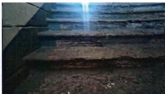
16. Ступени 1-ЛК. Сколы, трещины, истертости. (25.09.2023)
