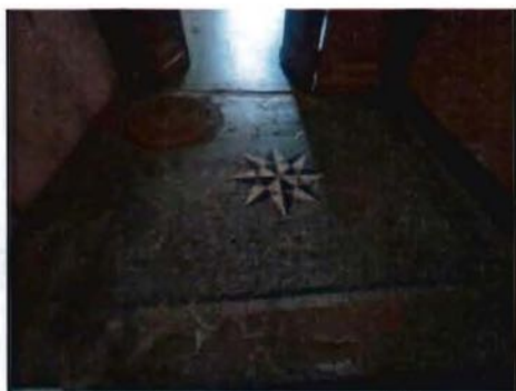
23. Покрытие полов 3-ЛК. Сколы, трещины. (25.09.2023)
