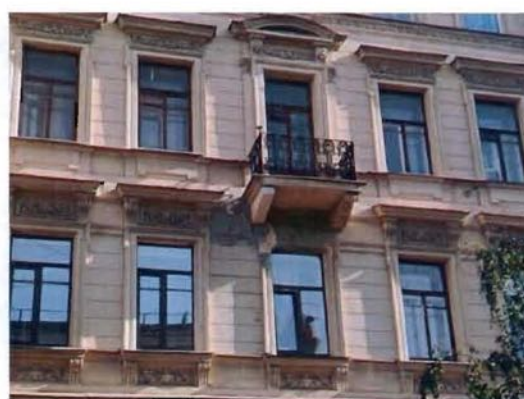
7. Фрагмент западного фасада. Фрагментарные участки утраты декора. (25.09.2023)
