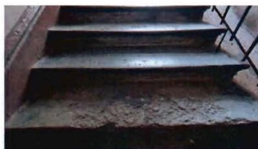
26. Ступени 3-ЛК. Сколы, трещины, истертости. (25.09.2023)
