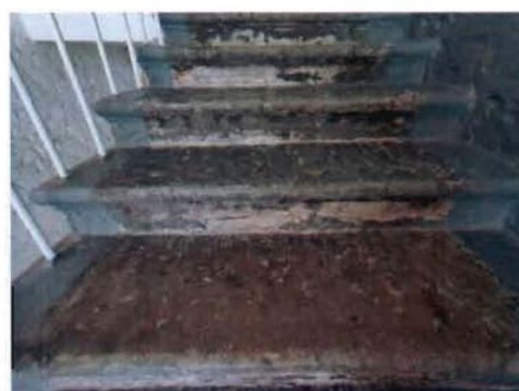
36. Ступени 2-ЛК. Сколы, трещины. (25.09.2023)
