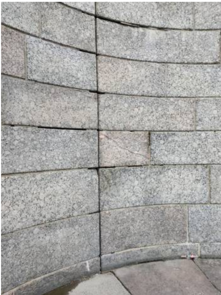
40. Правобережный спуск. Утраты шовного заполнения облицовки.
