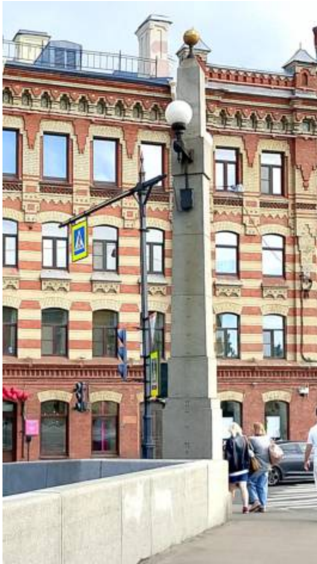
11. Северо-западный фонарь: отверстия от монтажа сетей, потёки ржавчины.
