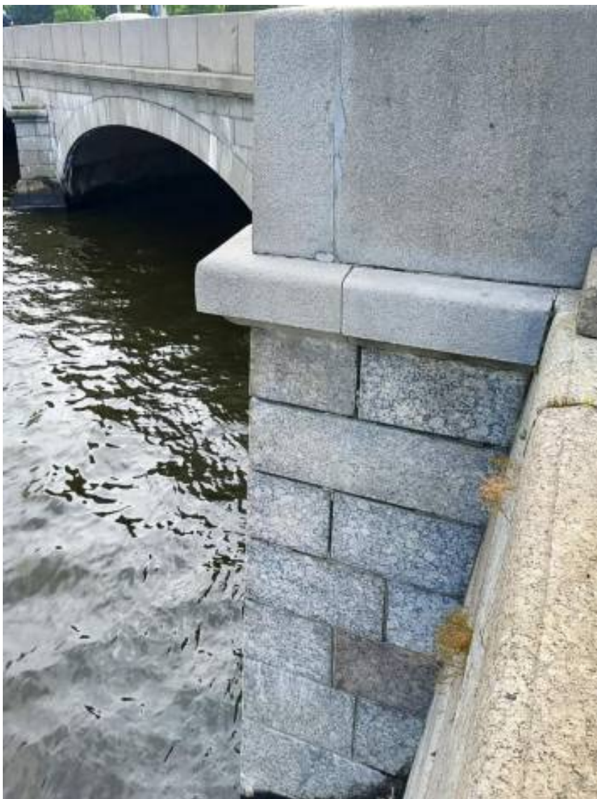
2. Верховой правобережный открылок. Утраты шовного заполнения облицовки, сколы грани парапетного камня (замастикованы).
