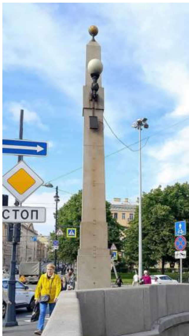
3. Северо-восточный фонарь: отверстия от монтажа сетей, потёки ржавчины.
