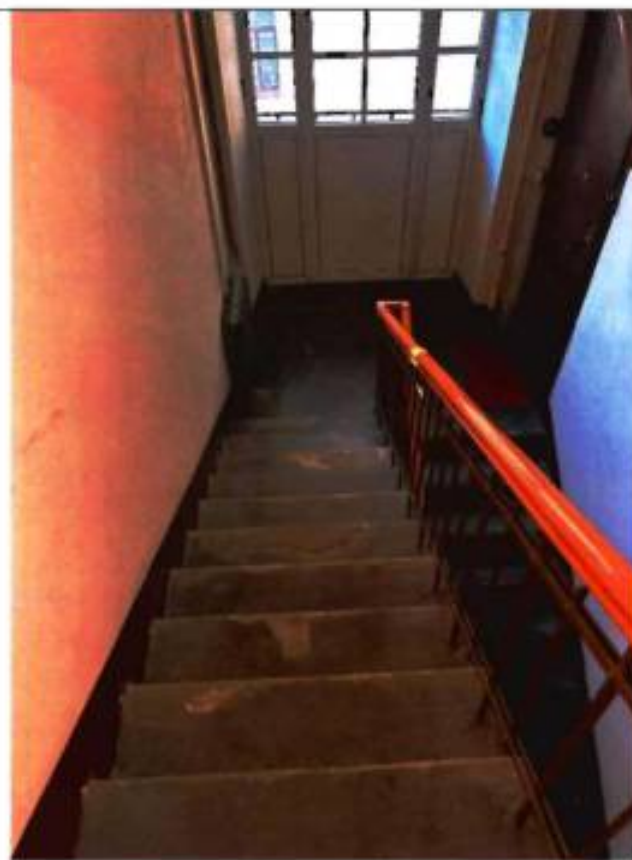
50. Лестница 3ЛК. Дефекты.
