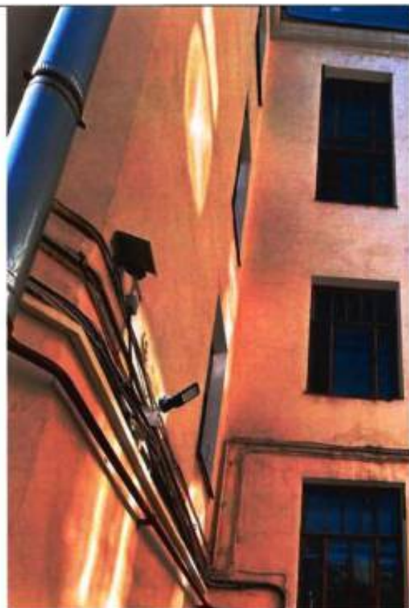
32. Фрагмент северо-восточного дворового фасада. Видеокамера.
