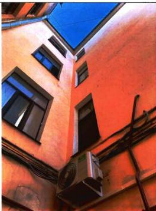
29. Фрагмент северо-восточного дворового фасада. Дефекты.
