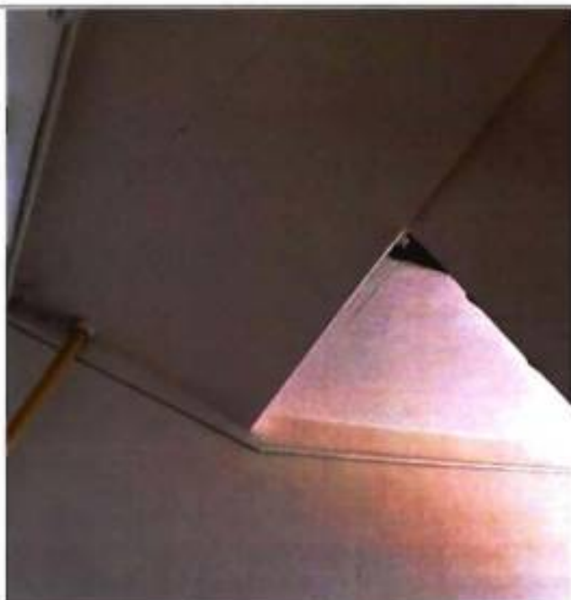
47. Лестница 2ЛК. Трещина.
