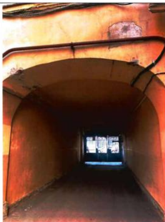
21. Воротный проезд. Дефекты.
