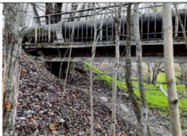
Фото 78. Ж/б конструкции акведука через Тярлевский ручей
