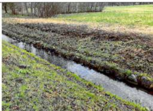
Фото 65. Мощение канала булыжным камнем имеет нарушения.
