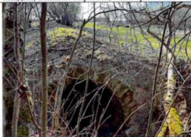
Фото 28. Вход в кирпичную галерею в месте разрушения
