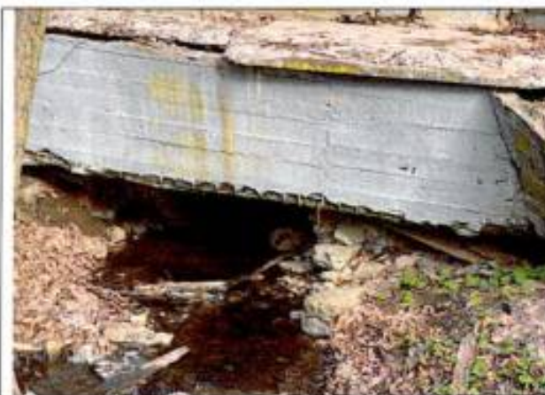
Фото 107. Павловск, ул. Красного курсанта. Мост на ручье. Разрушение западного фасада, обетонированные конструкции
