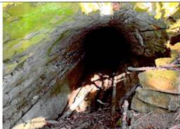
Фото 29. Кирпичная подземная галерея, вид внутри. Утрата шовного раствора, нарушение кладки, биопоражение
