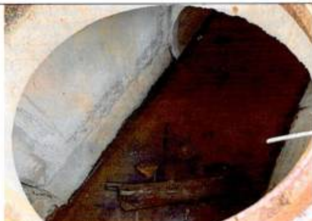
Фото 56. Ж/б труба участка подземной трубы от Баурского канала до гранитного бассейна и колодец на ней
