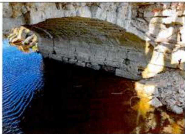
Фото 24. Акведук через р. Кузьминку. Дефекты свода моста, вывалы камня
