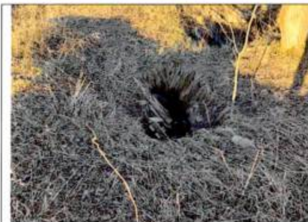
Фото 11. Провалы кирпичной галереи в Новокондакопшино
