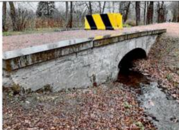
Фото 68. Мостик через канал на аллее. Известняковая облицовка низового фасада. Имеется трещина по фасаду
