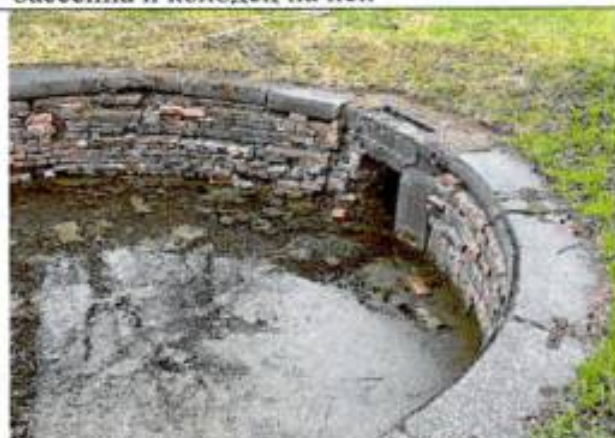
Фото 58. Кирпичная кладка стен бассейна разрушается, имеются вывалы кирпичей, связующий раствор частично утрачен
