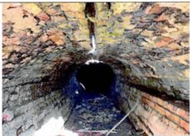
Фото 26. Вид изнутри кирпичной галереи у акведука через р. Кузьминку. Поверхностная деструкция кирпичной кладки, вывалы кирпича, биопоражение
