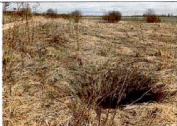
Фото 2. Воронка на месте колодца для обслуживания водовода
