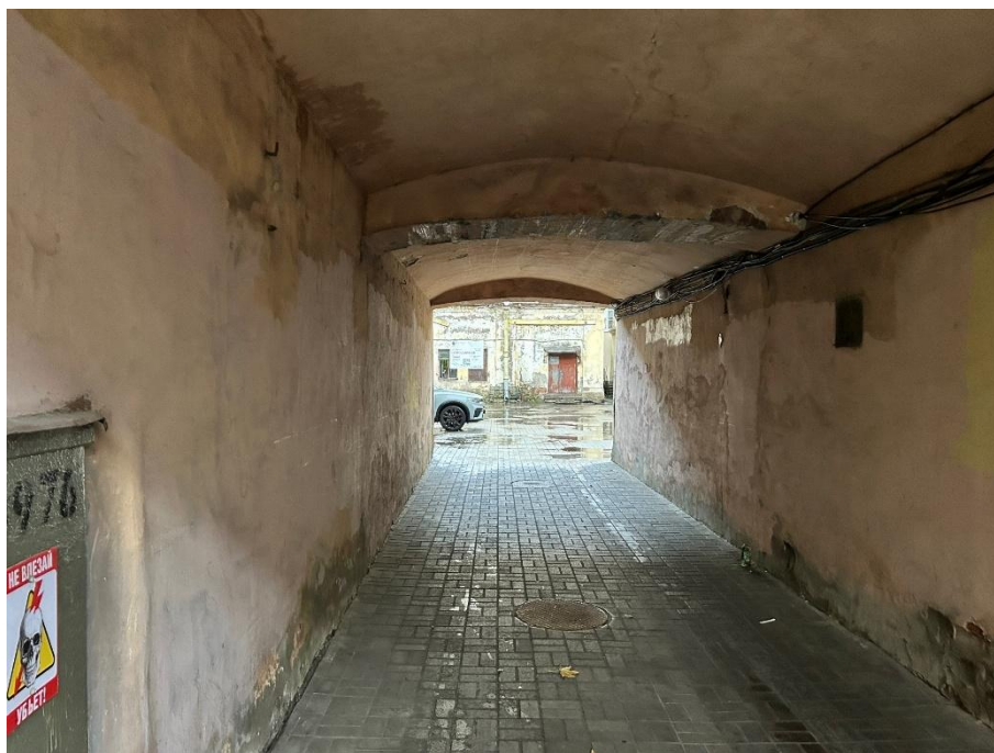
Фото №8. Дворовая арка, вид со стороны ул. Гончарной.
