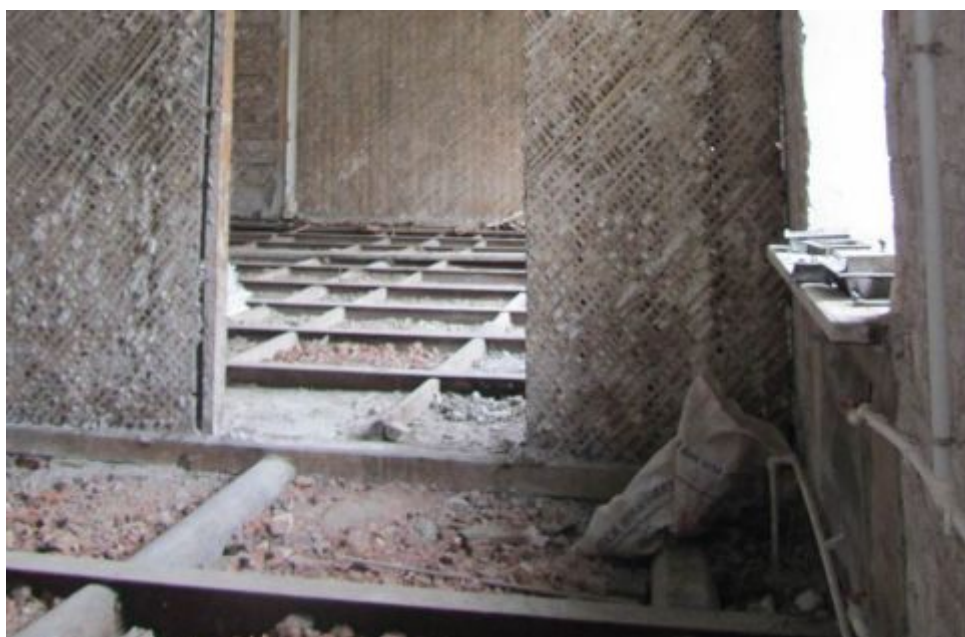
37. ОКН регионального значения «Жилой дом страхового общества “Россия” с садом и оградой» (г. Санкт-Петербург, Моховая ул., 27-29). Квартира № 34.
