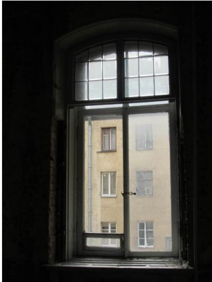
29. ОКН регионального значения «Жилой дом страхового общества “Россия” с садом и оградой» (г. Санкт-Петербург, Моховая ул., 27-29). Квартира № 34.
