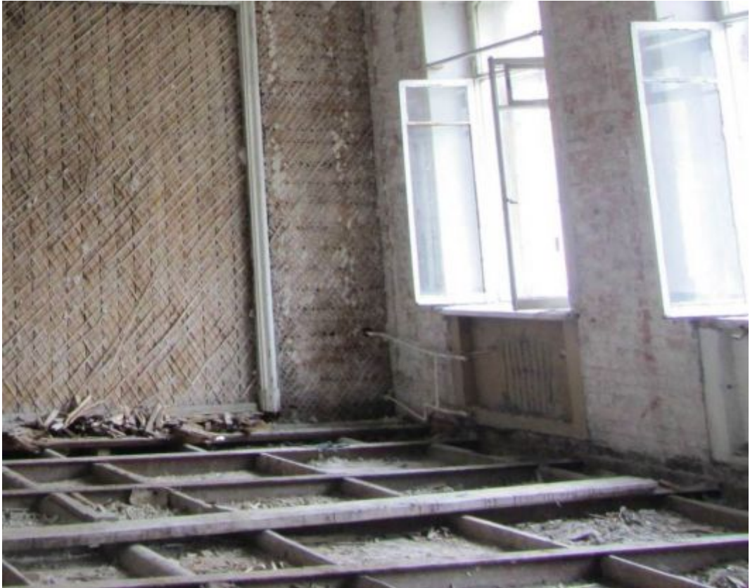
35. ОКН регионального значения «Жилой дом страхового общества “Россия” с садом и оградами» (г. Санкт-Петербург, Моховая ул., 27-29). Квартира № 34.
