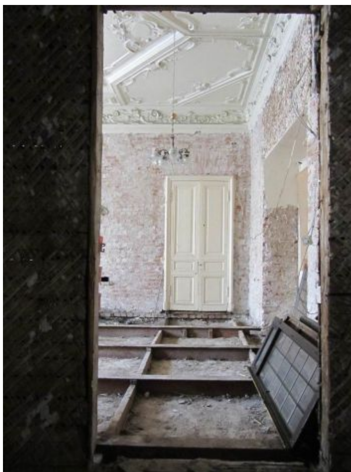
18. ОКН регионального значения «Жилой дом страхового общества “Россия” с садом и оградами» (г. Санкт-Петербург, Моховая ул., 27-29). Квартира № 34.
