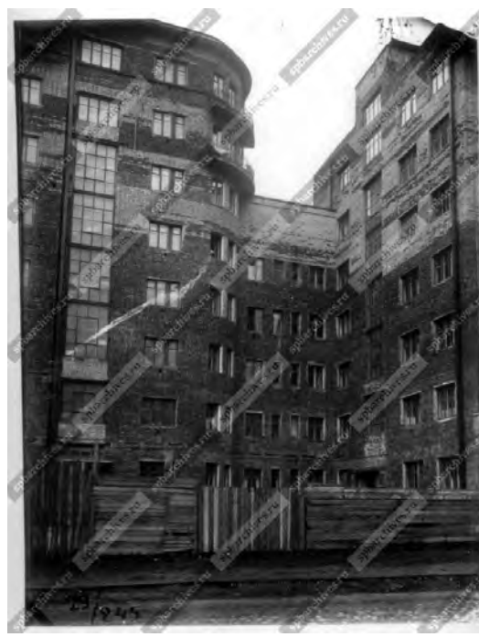
20. 1934-1937 гг. Фасад корп.№1 Дома специалистов на Лесном пр., 61 на этапе строительства. (ЦГАКФФД).
