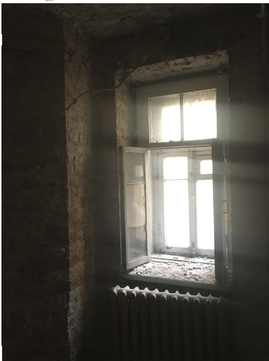
Фото №18. Квартира №45, оконное заполнение.
