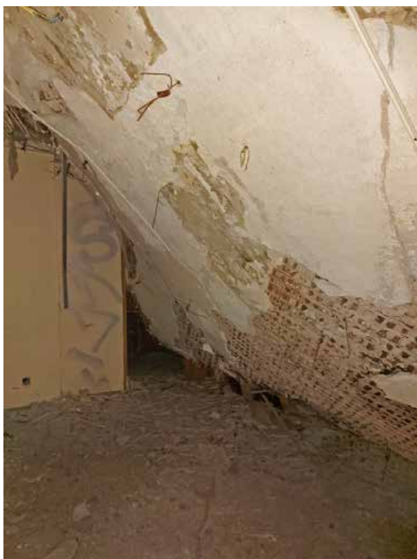
Фото 14. Помещение 20, обрушение перекрытия.
