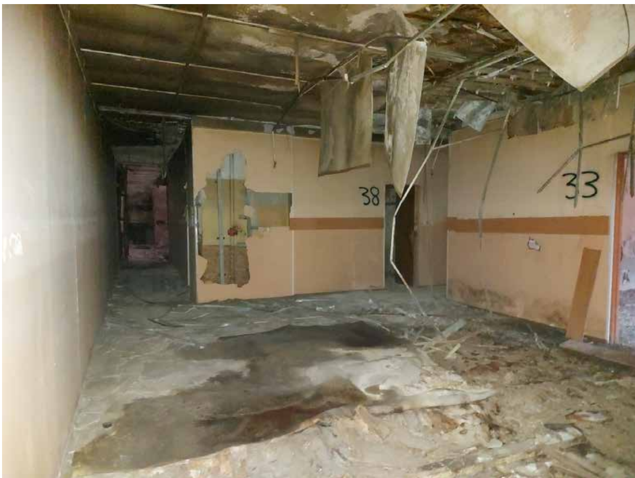
Фото 43. Помещение центрального корпуса, разрушение перекрытия.
