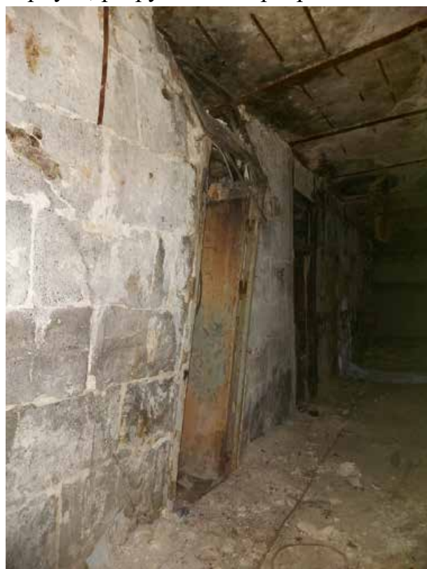
Фото 45. Коридор центрального корпуса, разрушение перекрытия.
