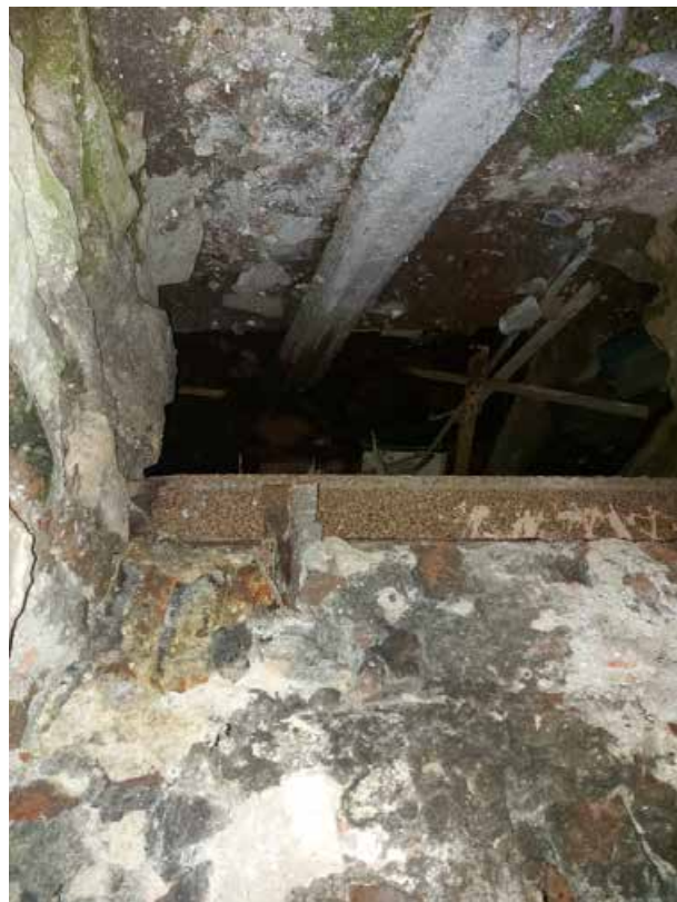
Фото 19. Проем в подвал, недоступен.
