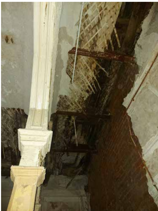
Фото 23. Разрушение перекрытия в парадной лестнице.
