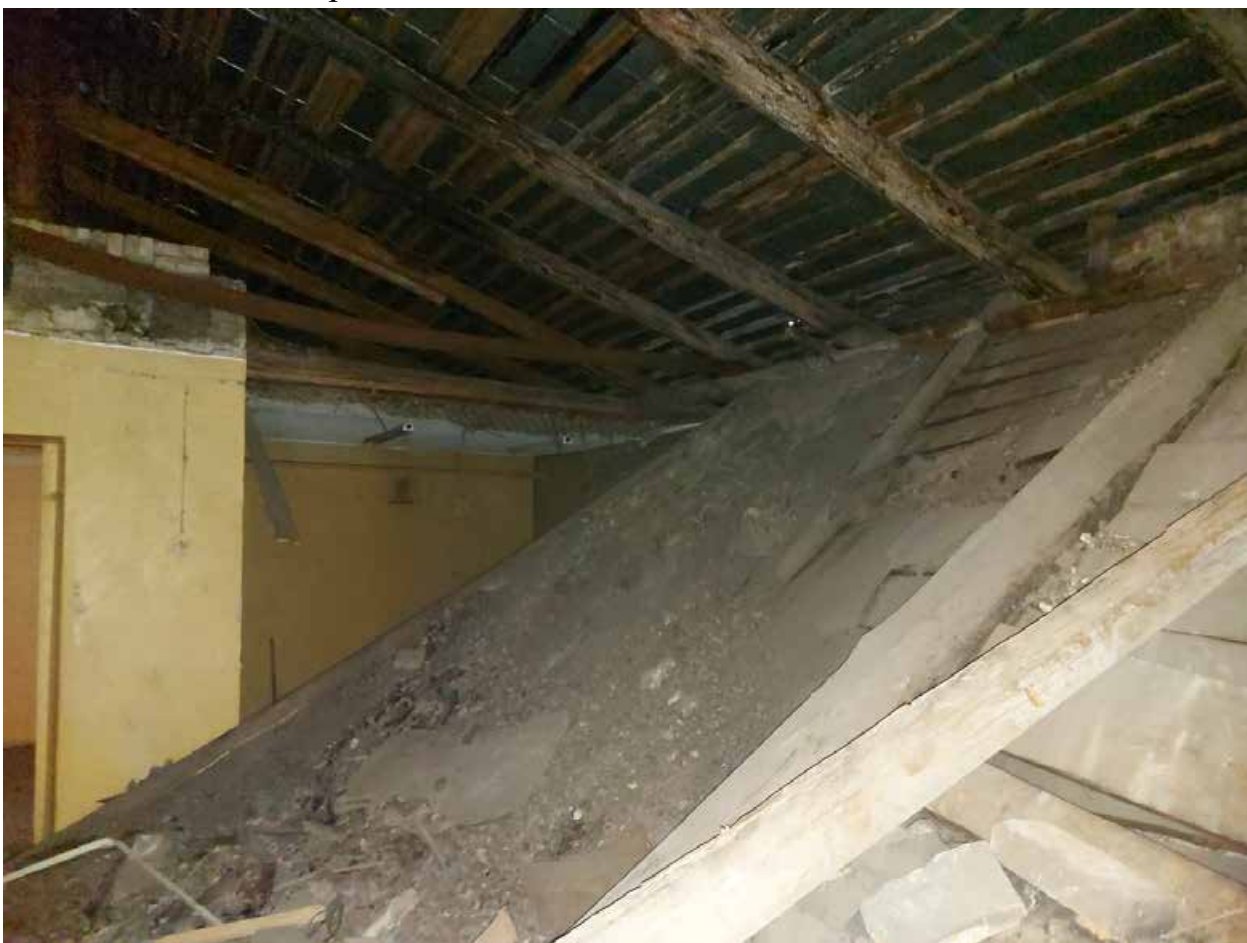
Фото 35. Обрушение перекрытия третьего этажа в пом.7.
