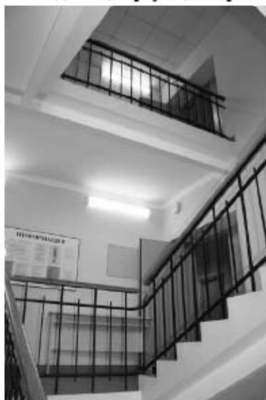
Фото 153. Общий вид на лестничную клетку. 4-й этаж. Здание общежития №56 (восточный корпус). Адрес: СПб, Парголовская улица, дом 11, корпус 2, литера А.
