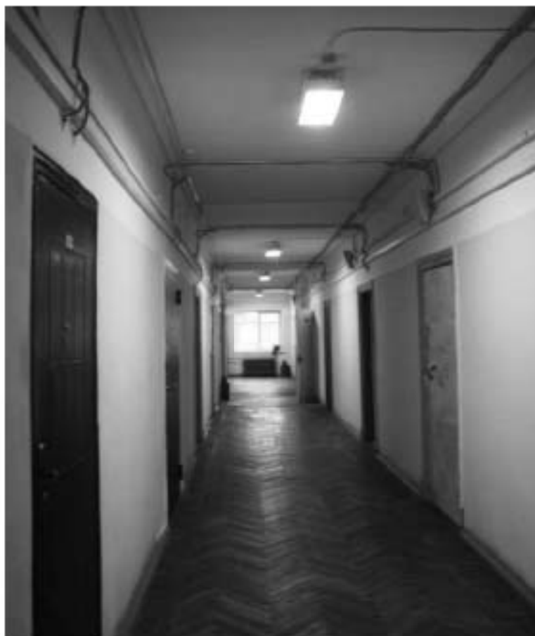
Фото 187. Общий вид типовой коридор общежития. 4-й этаж. Здание общежития №4а (северные корпуса). Адрес: СПб, Парголовская улица, дом 11, корпус 1, литера А.
