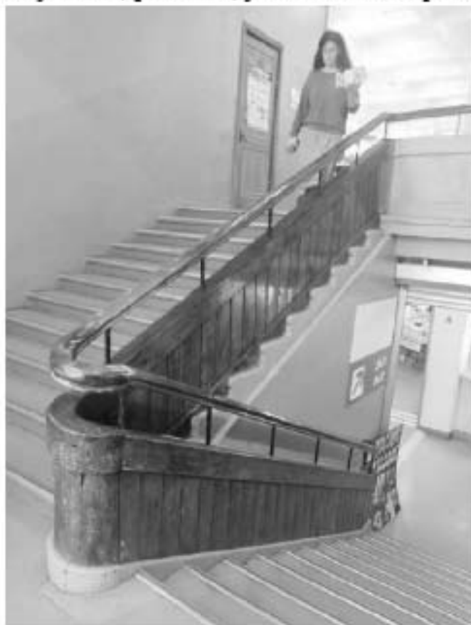
Фото 98. Общий вид на помещение 83 (лестничная клетка). 3-й этаж. Здание фабрики-кухни. Адрес: СПб, ул. Капитана Воронина, 13, лит. А.
