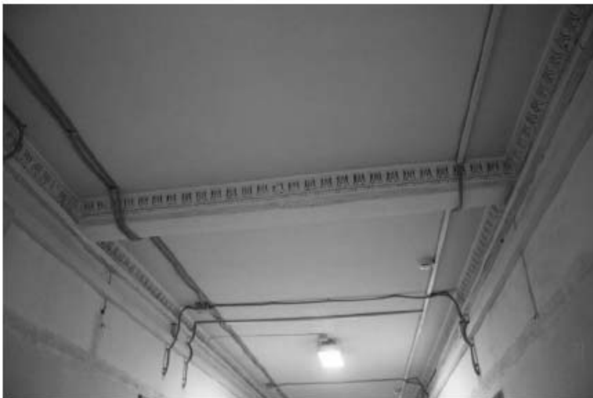
Фото 165. Общий вид штукатурный декор потолка. 4-й этаж. Здание общежития №4 (южные корпуса). Адрес: СПб, Парголовская улица, дом 11, корпус 1, литера А.
