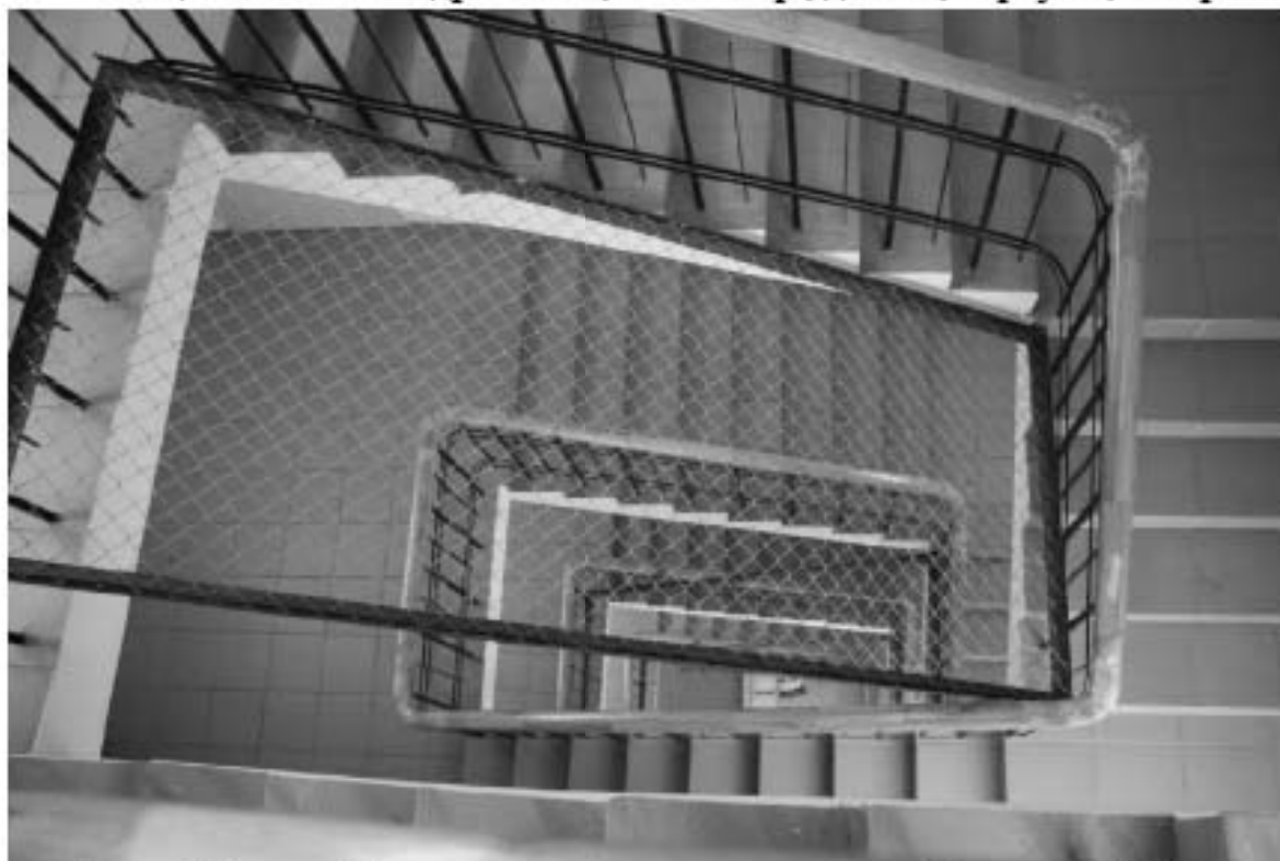
Фото 222. Общий вид на лестничную клетку общежития. 5-й этаж. Здание общежития № 1. Адрес: СПб, Лесной пр., дом 65, корпус 1, лит. А.
