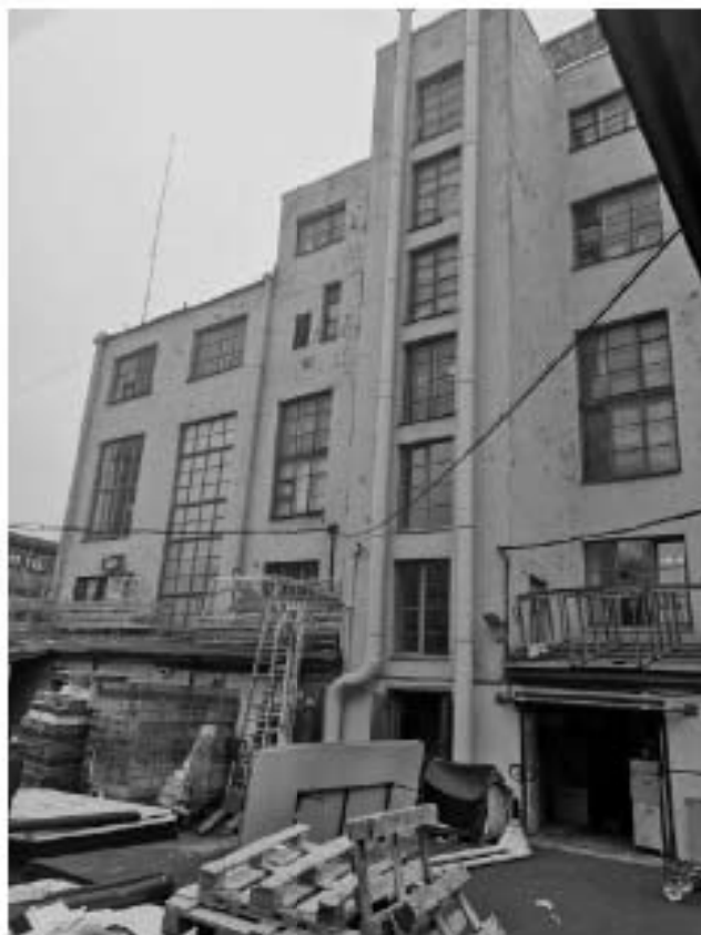
Фото 29. Вид на дворовый фасад КВЦ «Евразия». Адрес: СПб, ул. Капитана Воронина, д 13, лит. А
