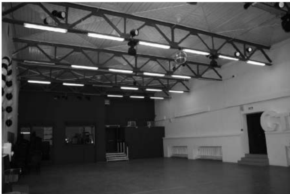
Фото 142. Общий вид на помещение проекторской зрительного зала. Здание клуба. Адрес: СПб, Парголовская улица, дом 11, корпус 2, литера А.
