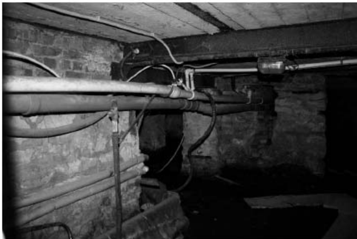
Фото 175. Общий вид подвальное помещение. Здание общежития №4а (северные корпуса). Адрес: СПб, Парголовская улица, дом 11, корпус 1, литера А.
