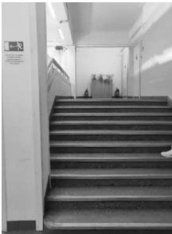
Фото 103. Общий вид на парадную лестничную клетку. 1-й этаж. Здание фабрики-кухни. Адрес: СПб, ул. Капитана Воронина, 13, лит. А.
