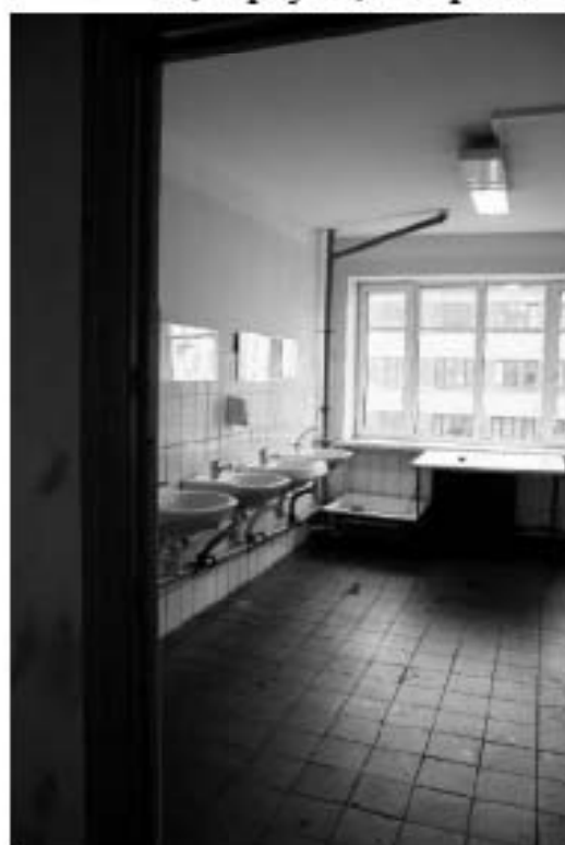
Фото 172. Общий вид типовой санузел. 5-й этаж. Здание общежития №4 (южные корпуса). Адрес: СПб, Парголовская улица, дом 11, корпус 1, литера А.
