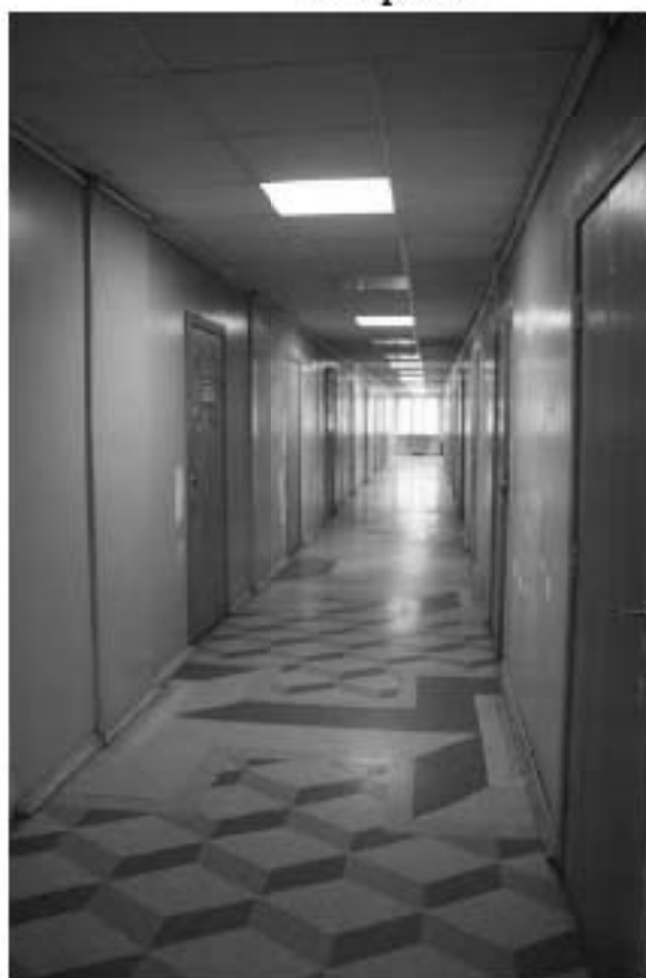
Фото 147. Общий вид на типовой коридор общежития. 3-й этаж. Здание общежития №5 (западный корпус). Адрес: СПб, Парголовская улица, дом 11, корпус 2, литера А.
