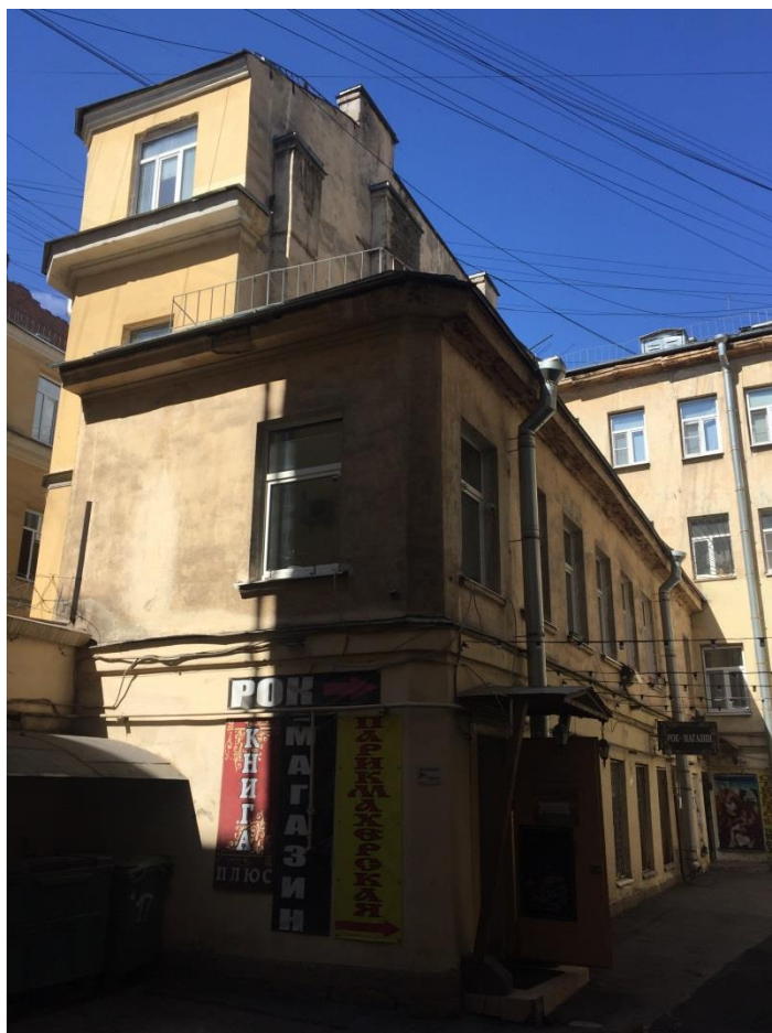
Фото 5. Юго-восточный и северо-восточный фасады дворового флигеля под лит. А 3 . Вид с юго-востока.
