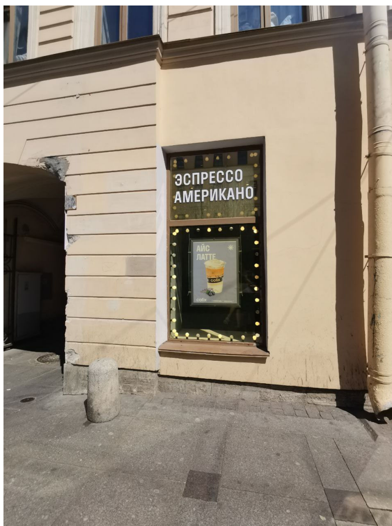
Фото№4: Фрагмент лицевого фасада. Существующее позднее оконное заполнение на месте дверного проема
