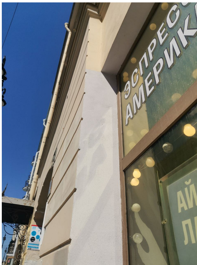
Фото№7: Фрагмент существующего позднего оконного заполнения. Общее загрязнение фасада
