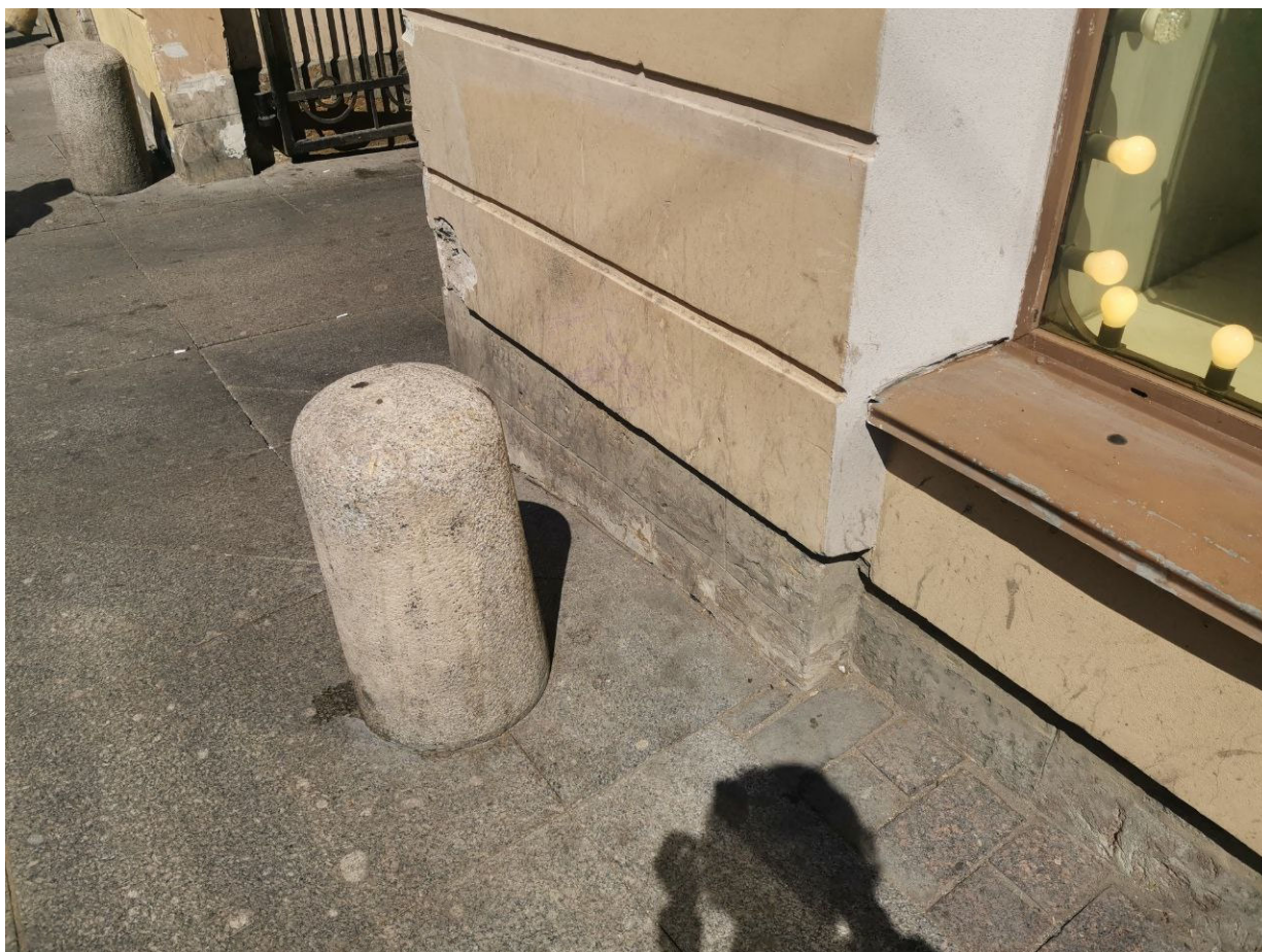
Фото№11: Фрагмент фасада у оконного заполнения. Общее загрязнение фасада, механические повреждения штукатурного слоя
