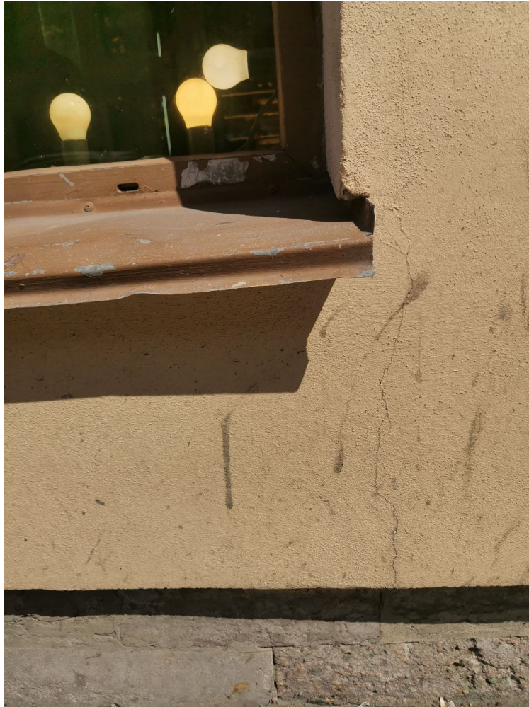
Фото№9: Фрагмент существующего оконного заполнения. Загрязнение фасада. Трещина, раскрытием до 1 мм в месте закладки исторического дверного проема
