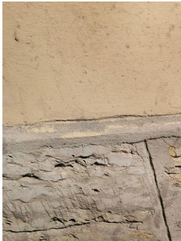
Фото№10: Фрагмент цоколя здания. Выветривание глинистых слоев Путиловского известняка. Домастиковка составами на основе цементного вяжущего
