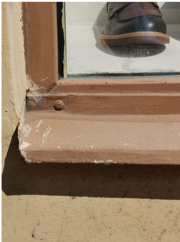
Фото№5: Фрагмент существующего оконного заполнения в неудовлетворительном состоянии. Многочисленные слои красочного состава. Неправильная установка отлива
