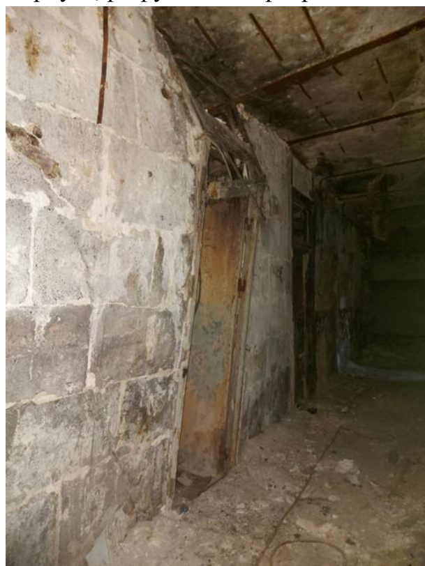
Фото 106. Коридор центрального корпуса, разрушение перекрытия.
