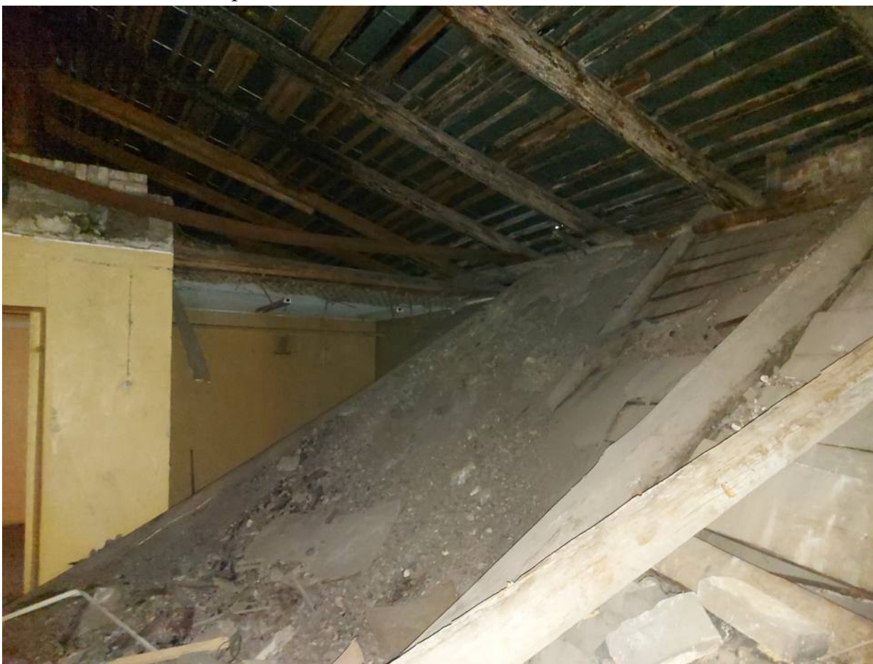
Фото 61. Обрушение перекрытия третьего этажа в пом.7.
