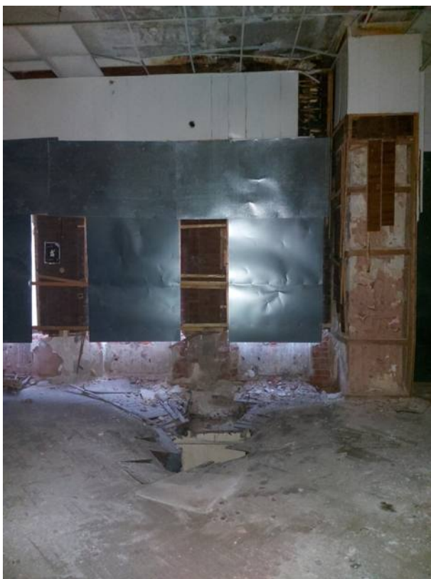
Фото 44. Помещение 14, разрушение перекрытия.
