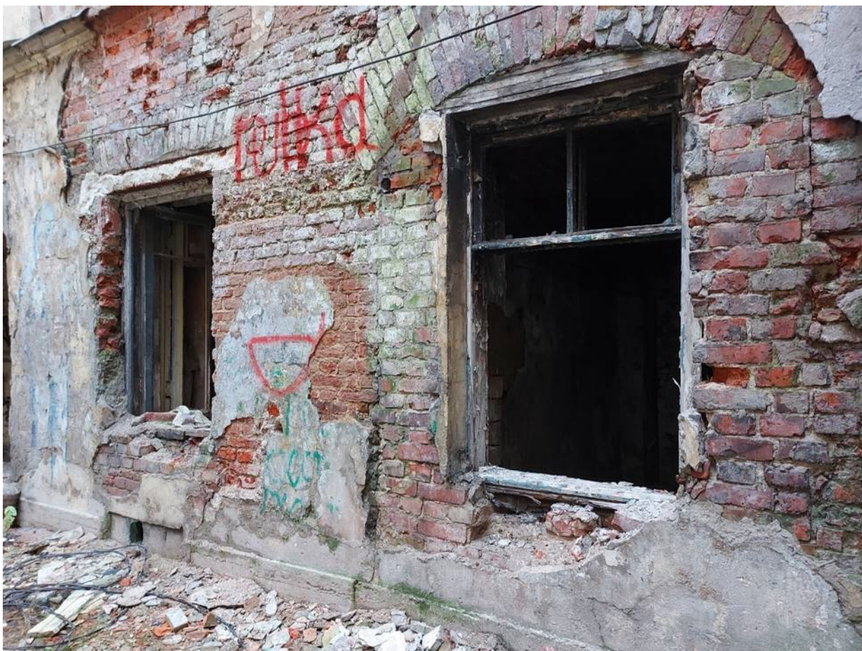
Фото 11. Проемы первого этажа.
