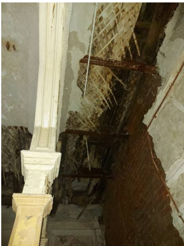
Фото 38. Разрушение перекрытия в парадной лестнице.
