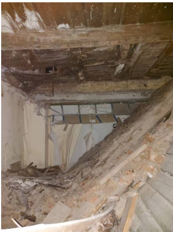
Фото 34. Помещение 20, разрушение перекрытия.
