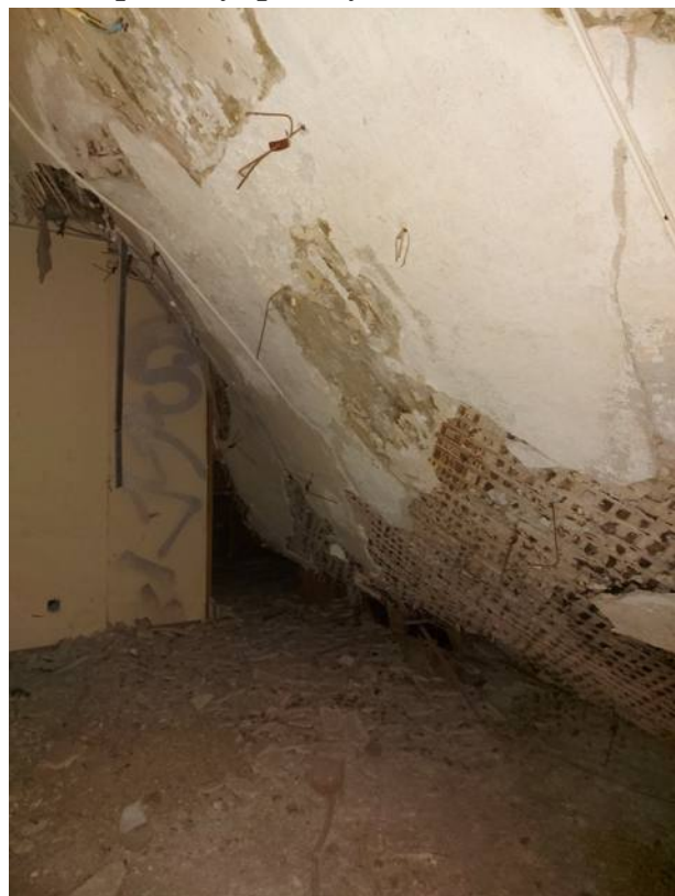
Фото 21. Помещение 20, обрушение перекрытия.
