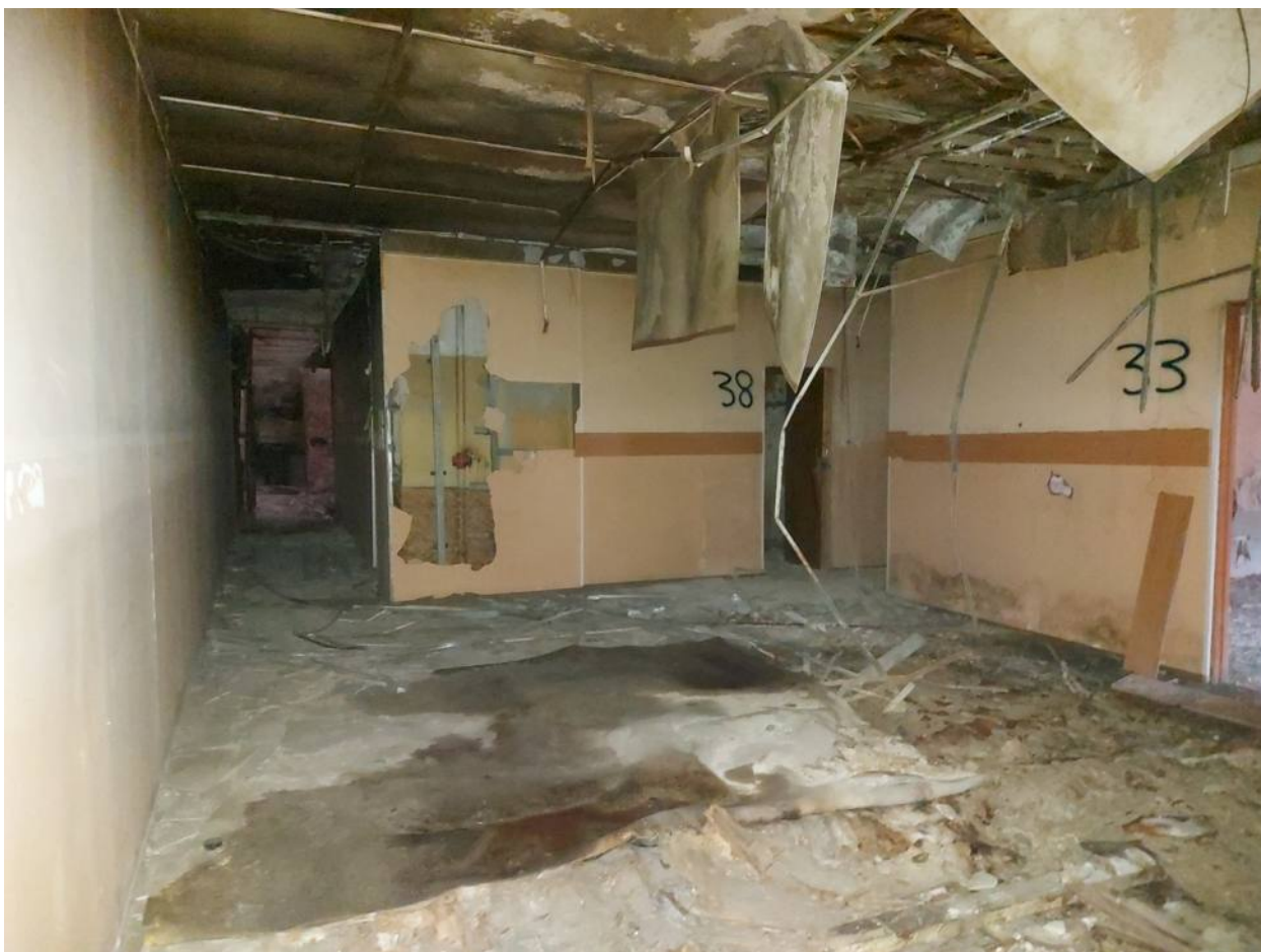
Фото 104. Помещение центрального корпуса, разрушение перекрытия.
