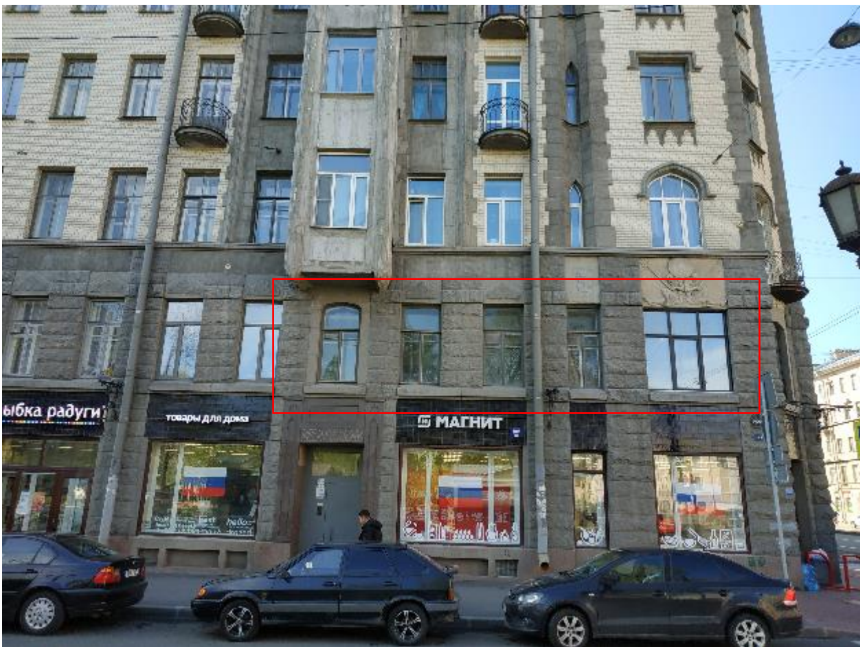
1. Оконные заполнения кв. №34 в уровне 2-го этажа выявленного объекта культурного наследия «Доходный дом сельскохозяйственного товарищества «Помещик»», расположенного по адресу: г. Санкт-Петербург, Измайловский пр., д. 16/30, литера А, по 7-ой Красноармейской. 15.09.2020.
