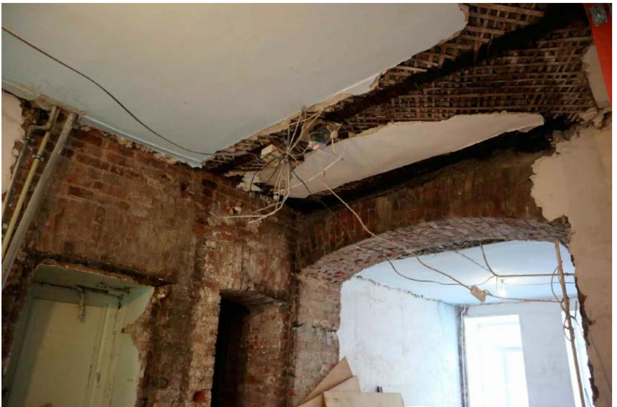
8. Помещения №№5, 1, 10 кв. №34 в уровне 2-го этажа выявленного объекта культурного наследия «Доходный дом сельскохозяйственного товарищества «Помещик»», расположенного по адресу: г. Санкт-Петербург, Измайловский пр., д. 16/30, литера А. 15.09.2020.
