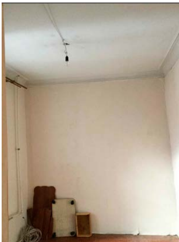
6. Помещение №7 кв. №34 в уровне 2-го этажа выявленного объекта культурного наследия «Доходный дом сельскохозяйственного товарищества «Помещик»», расположенного по адресу: г. Санкт-Петербург, Измайловский пр., д. 16/30, литера А. 15.09.2020.
