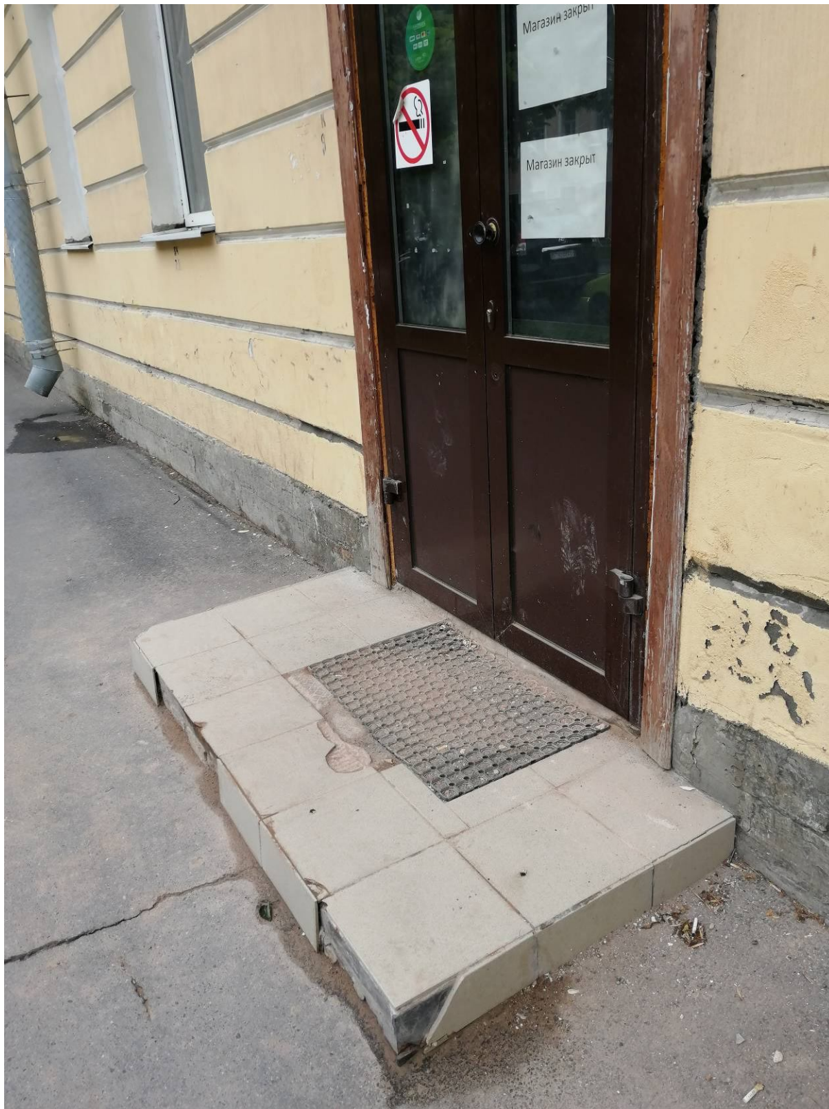
11. Фрагмент лицевого фасада дома №43 со стороны проспекта Ленина. Крыльцо перед главным входом.
