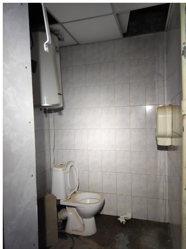
Фото 44. Помещение 17 в северной части. Протечки.
