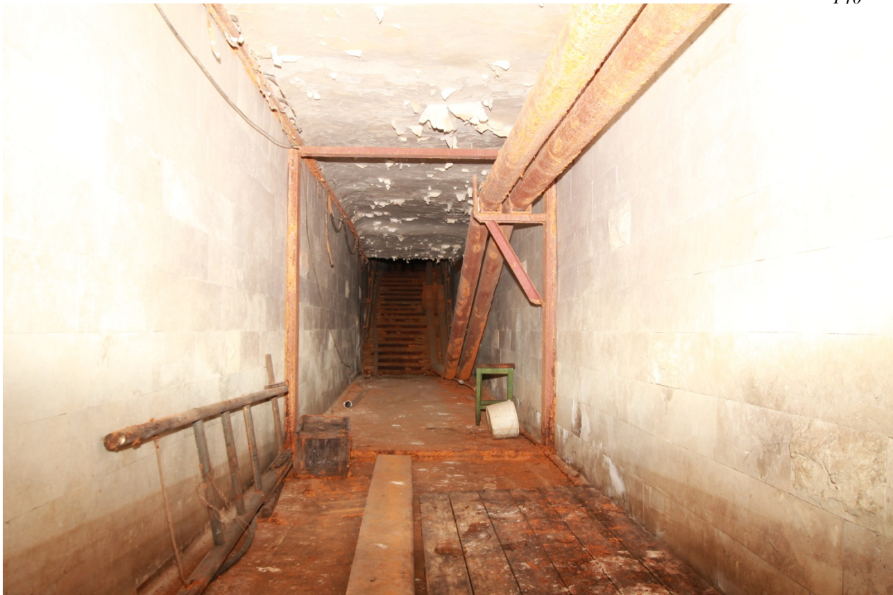
Фото 26. Подземный переход. Следы подтопления.
