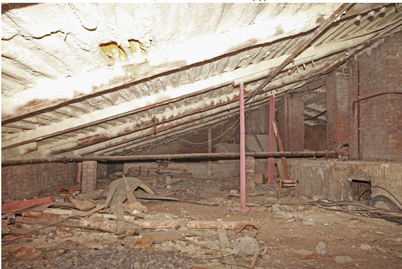
Фото 63. Северо-восточная часть. Разрушения и протечки кровли.
