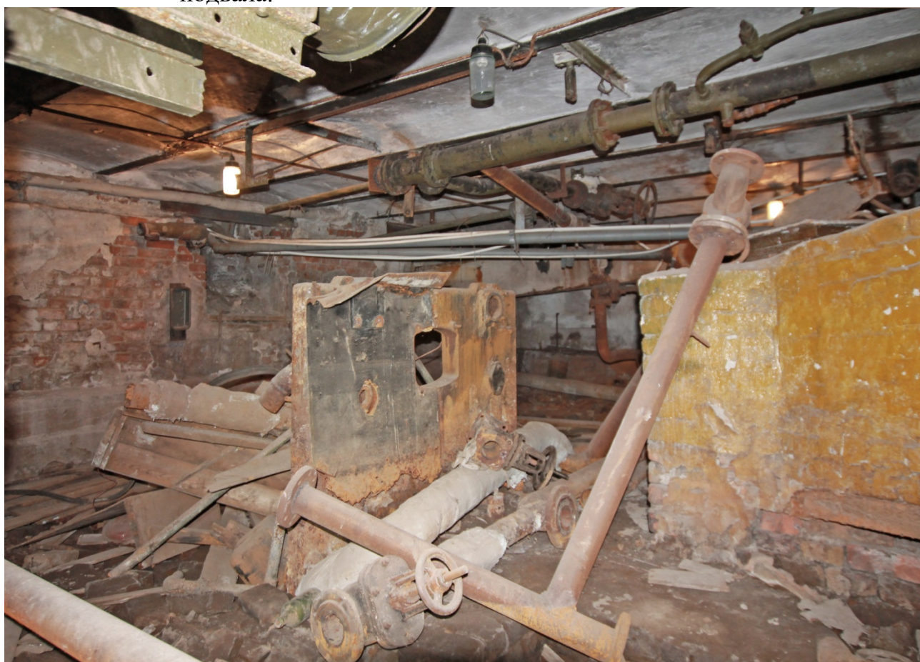
Фото 25. Помещение 3. Инженерное оборудование.
