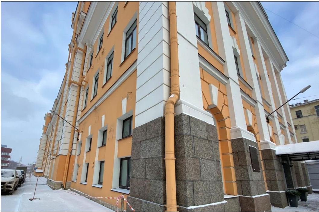
10. «Здание администрации Адмиралтейского судостроительного завода», ул. Лоцманская, д.3, лит. А. Южный фрагмент фасада. Фото 10.02.2021 г.
