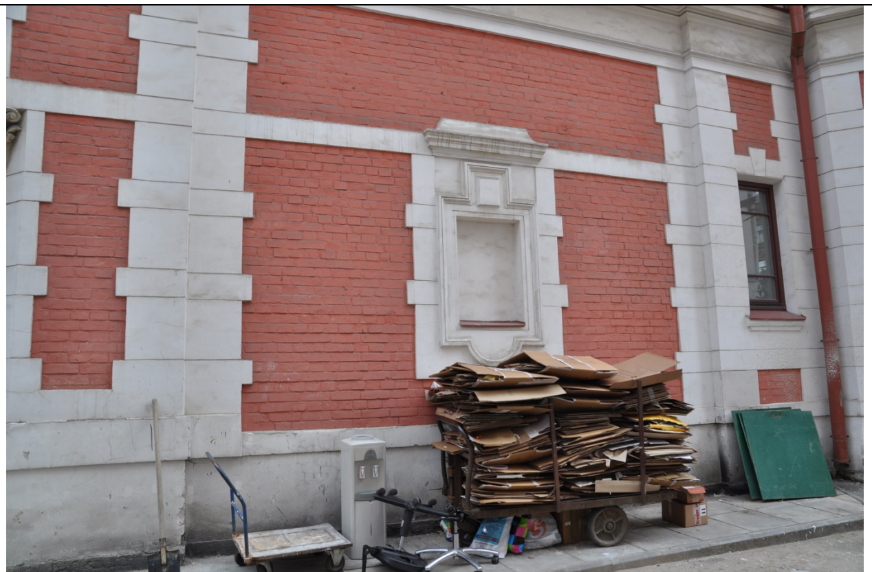
Фото 28. Фрагмент Юго-Западного фасада на уровне первого этажа в осях В-А. (23.09.2020 г.)
