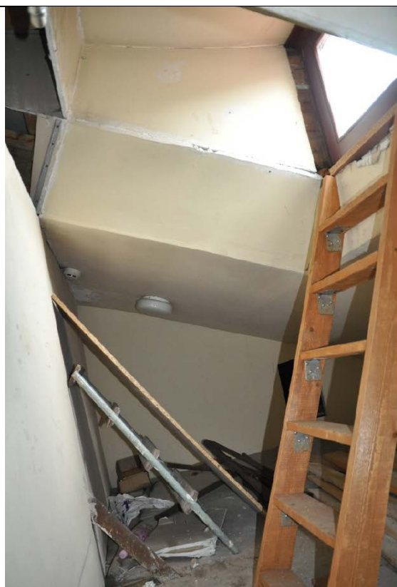
Фото 80. Помещение №23 в осях 2-3. Подкровельное пространство. (23.09.2020 г.)
