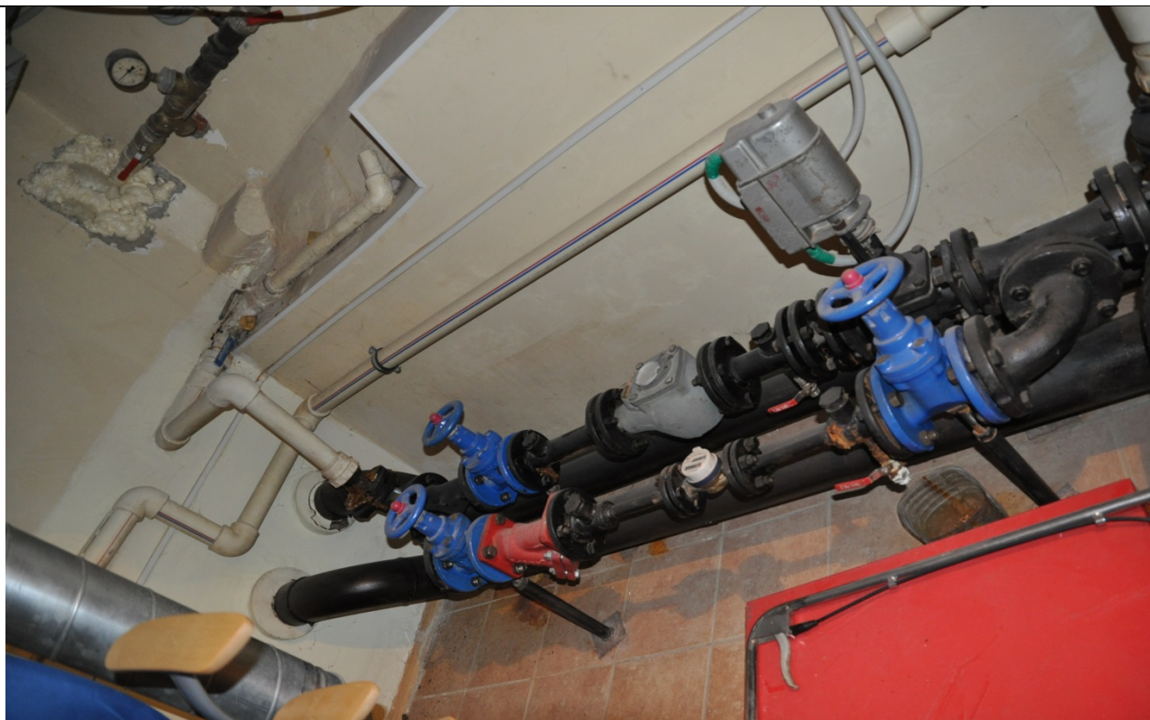
Фото 88. Помещение №26 в осях 1-2 на уровне подвала. Водомерный узел. (23.09.2020 г.)
