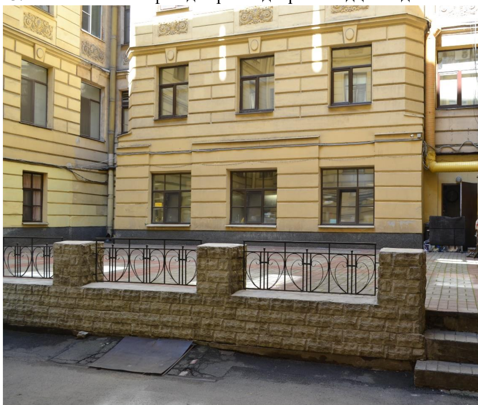
Фото 4. Фрагмент юго-восточного фасада первого двора-колодца. На первом этаже находится нежилое помещение 3-Н. Вид с юго-востока
