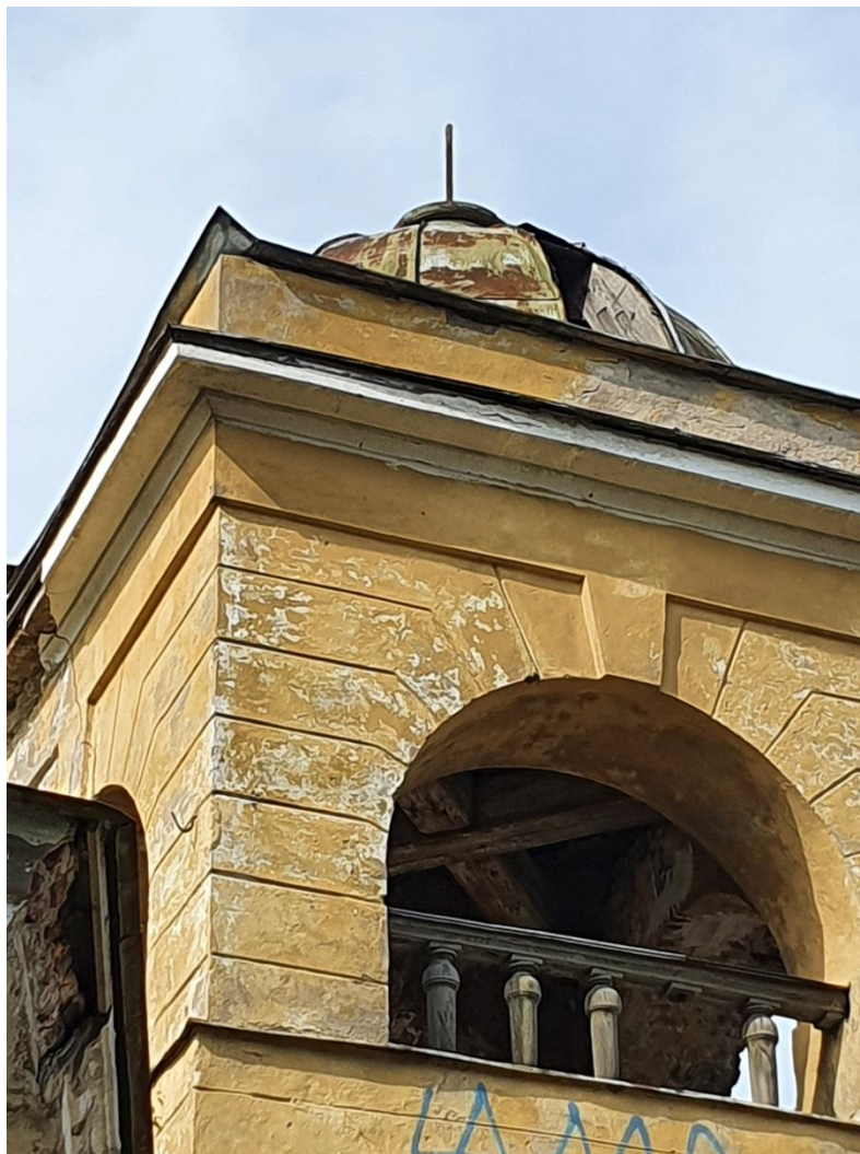
7. Объект культурного наследия регионального значения «Александровские ворота Охтинских пороховых заводов» по адресу: г. Санкт-Петербург, Химиков ул., д. 20 сооружение 1, Литера А Вид с северо-востока Дата съемки: 10 сентября 2020 г.
