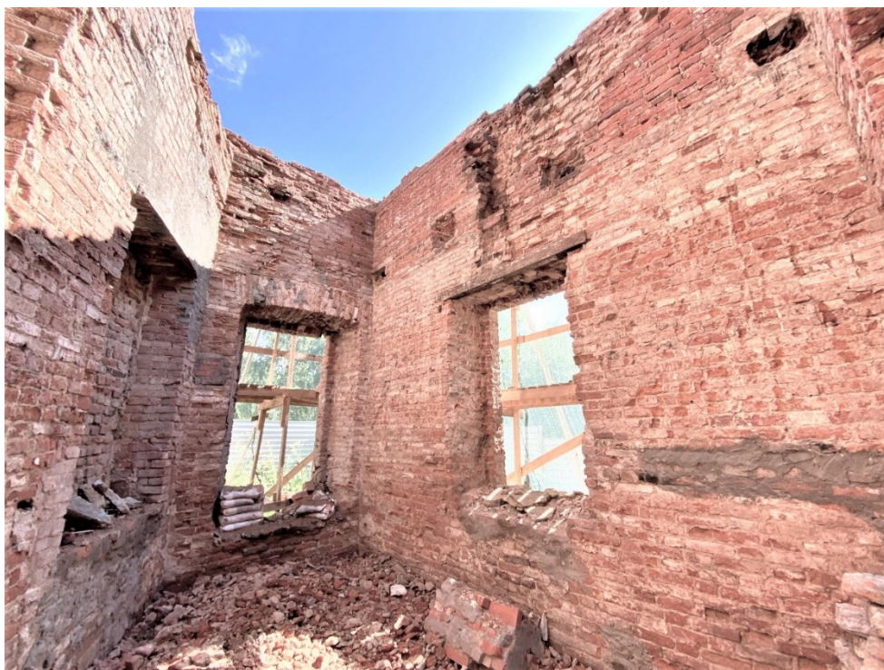
22. Объект культурного наследия регионального значения «Александровские ворота Охтинских пороховых заводов» по адресу: г. Санкт-Петербург, Химиков ул., д. 20 сооружение 1, Литера А. Вид внутренних помещений. Фрагмент. Дата съемки: 30 сентября 2020 г.
