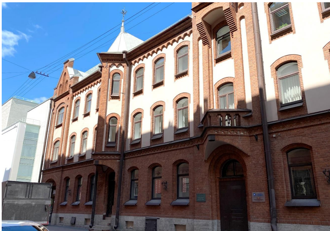
Фото 3. Юго-западный лицевой фасад. В уровне 2-го этажа оконные проемы нежилого помещения 6Н. Вид с юга
