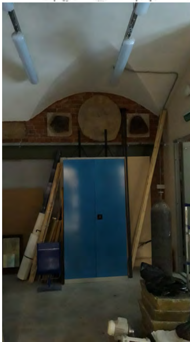
Фото 38. Объект культурного наследия федерального значения "Центральное училище технического рисования и музей Штиглица А.Л." по адресу: Санкт-Петербург, Соляной пер., д. 13-15, лит. А. Помещения 4-Н (4, 5, 6, 7, 8. 9)
