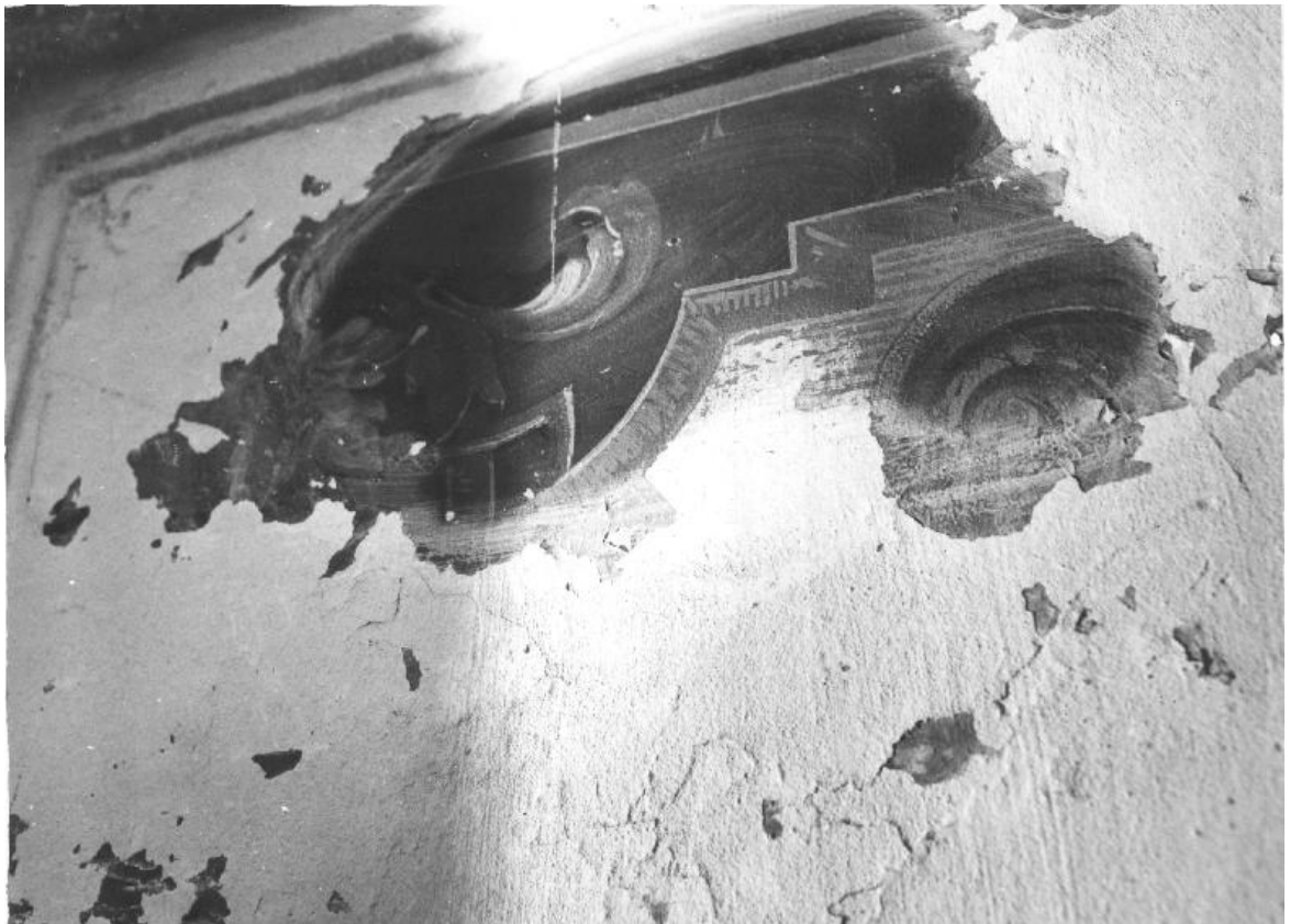
Илл. 51. Расчистка стенных панно от сплошной закраски. СНПО «Реставратор» Фотография. 1985 г. Архив КГИОП
