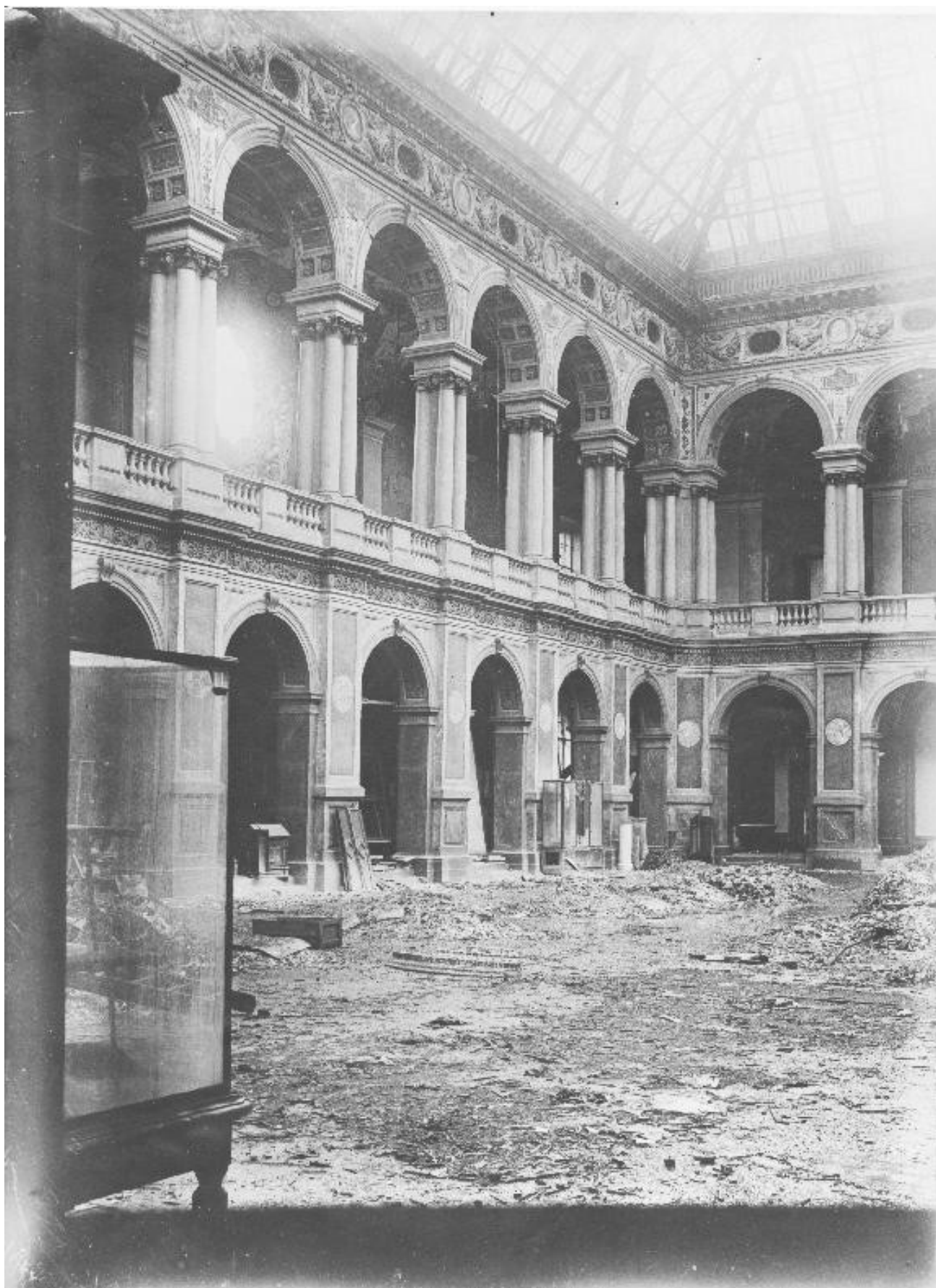
Илл. 43. Большой Выставочный зал Музея. Состояние помещения после попадания снаряда Октябрь 1941 г. Фотография Государственного Эрмитажа. Архив КГИОП
