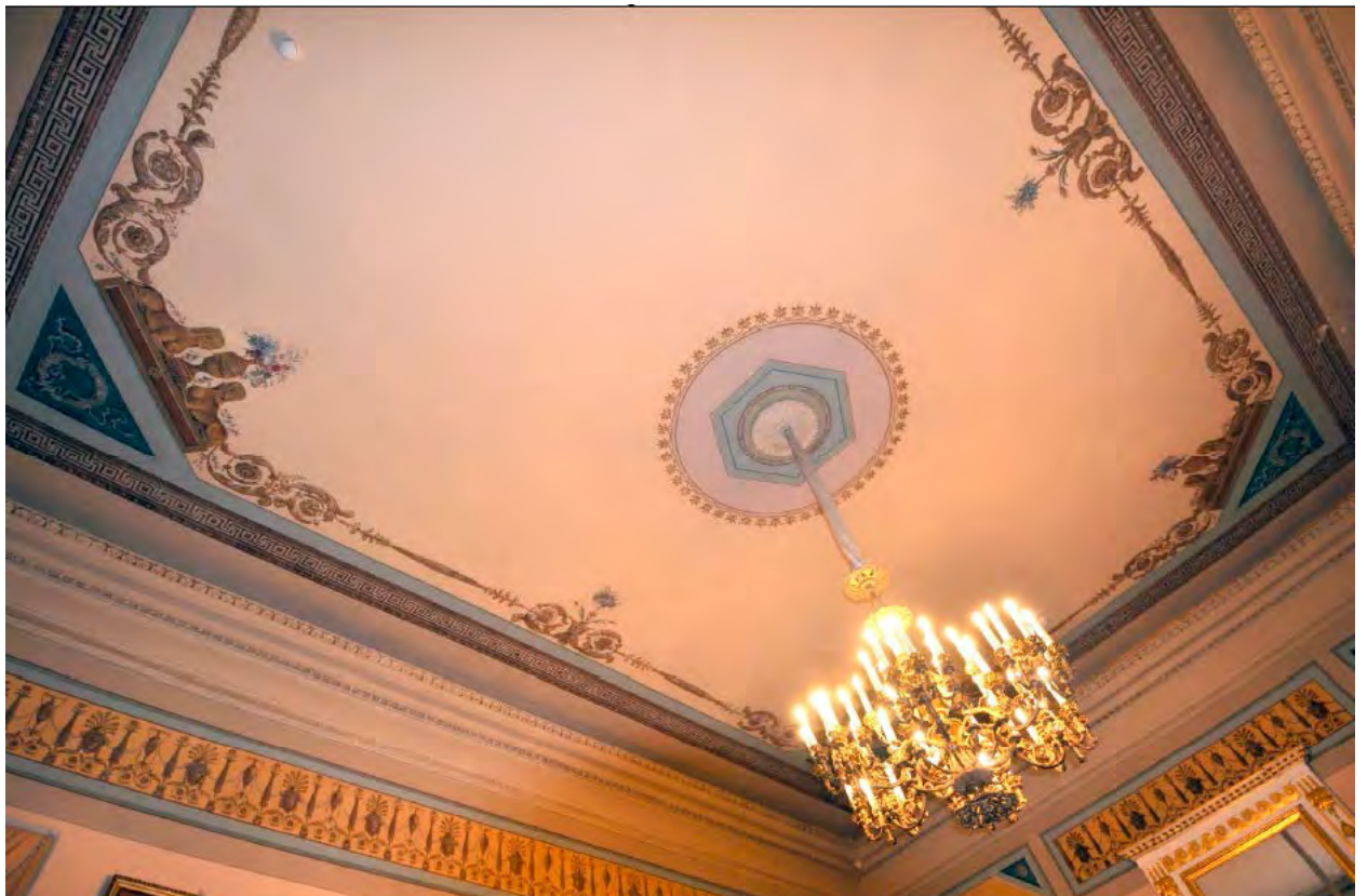
7. Потолок зала №12 (пом. 1-Н (136) в уровне 1-ого этажа объекта культурного наследия федерального значения «Дворец Таврический. Дворец», расположенного по адресу: г. Санкт-Петербург, ул. Шпалерная, д. 47, лит. А. 10.05.2021
