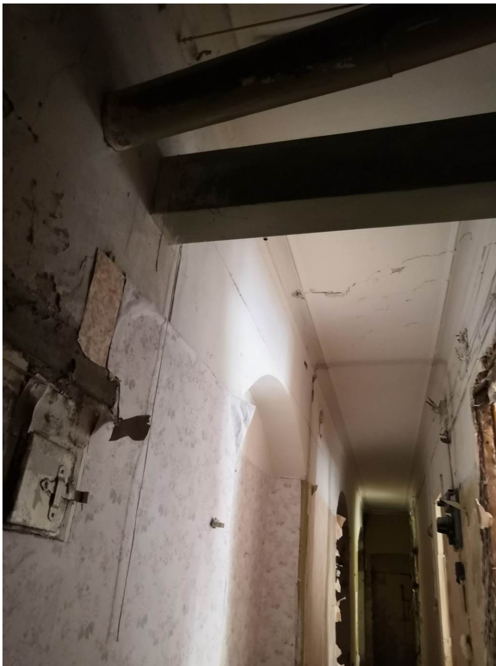
7. Выявленный ОКН «Дом К.А.Шрейбера» г. Санкт-Петербург, Фурштатская улица, дом 25, литера А. Помещение кв. № 8. Коридор
