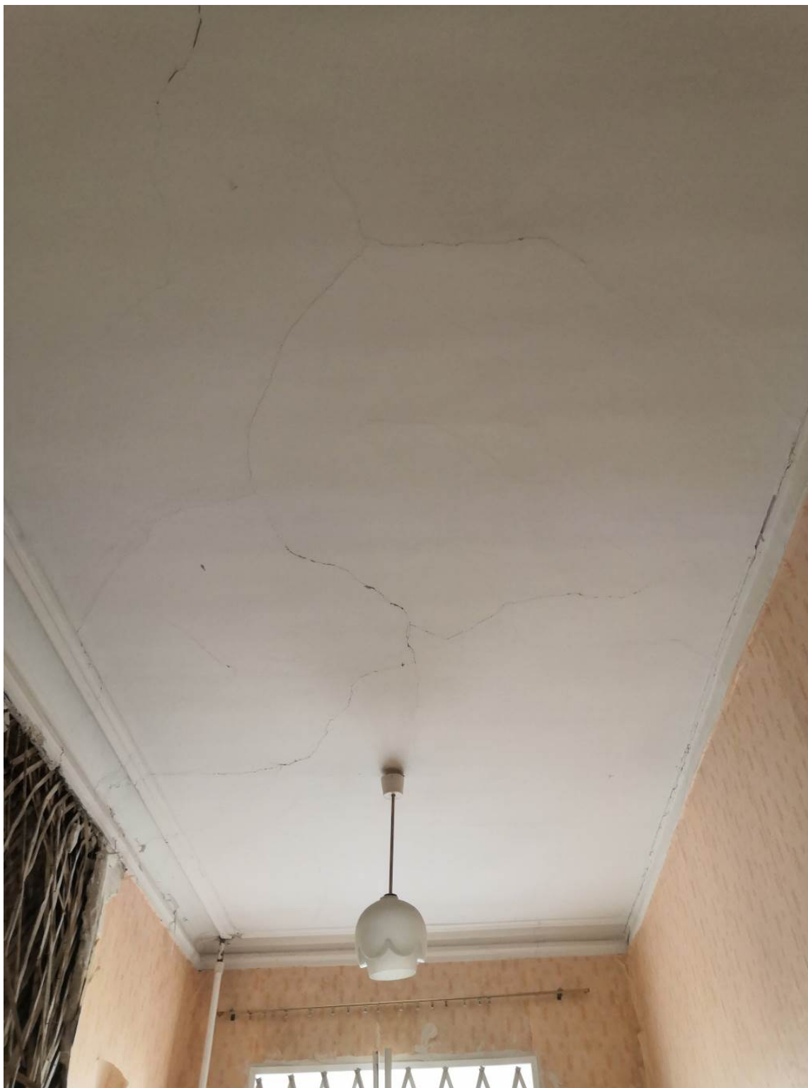
12. Выявленный ОКН «Дом К.А.Шрейбера» г. Санкт-Петербург, Фурштатская улица, дом 25, литера А. Помещение 3 в кв.№ 8. Комната.
