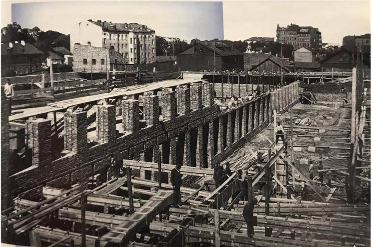
Илл. 34. Строительство цехов акционерного общества русских электротехнических заводов «Сименс и Гальске». (В.О., Кожевенная линия, д.39). Электронный портал pastvu.com .
