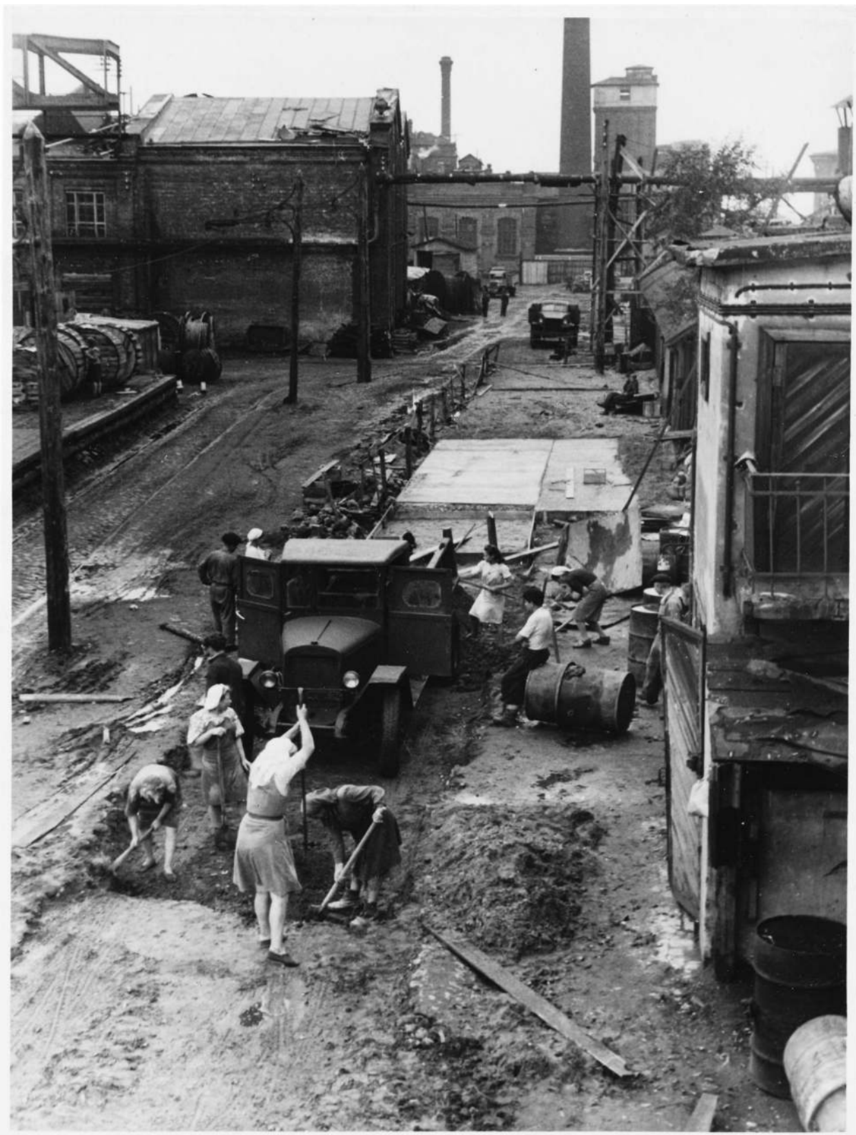
Илл. 40. Ленинградский кабельный завод «Севкабель». Реконструкция завода после войны. 1946-1960 гг. Электронный портал pastvu.com.
