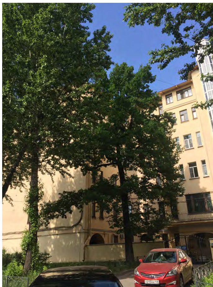
Илл. 6. Фрагмент дворового юго-западного фасада со стороны Лазаретного переуллка. Вид с юго-запада.
