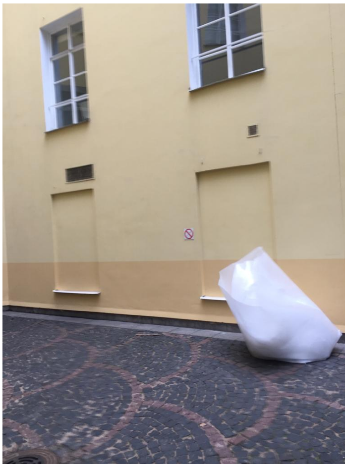
Фото 9. Заложенные оконные проемы 1-Н (ч.п. 3-34) со стороны дворового фасада.
