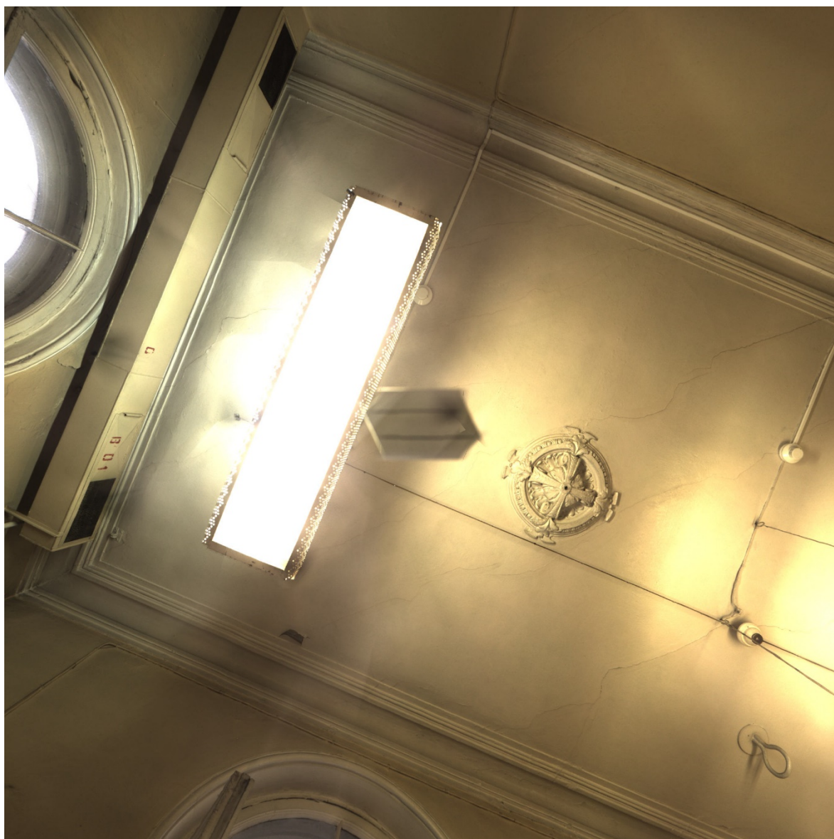
40. Помещение №33 в уровне 2-го этажа объекта культурного наследия федерального значения «Флигели (два). Флигель», расположенного по адресу: г. Санкт-Петербург, ул. Рентгена, д. 1 лит. Б. 31.07.2020.
