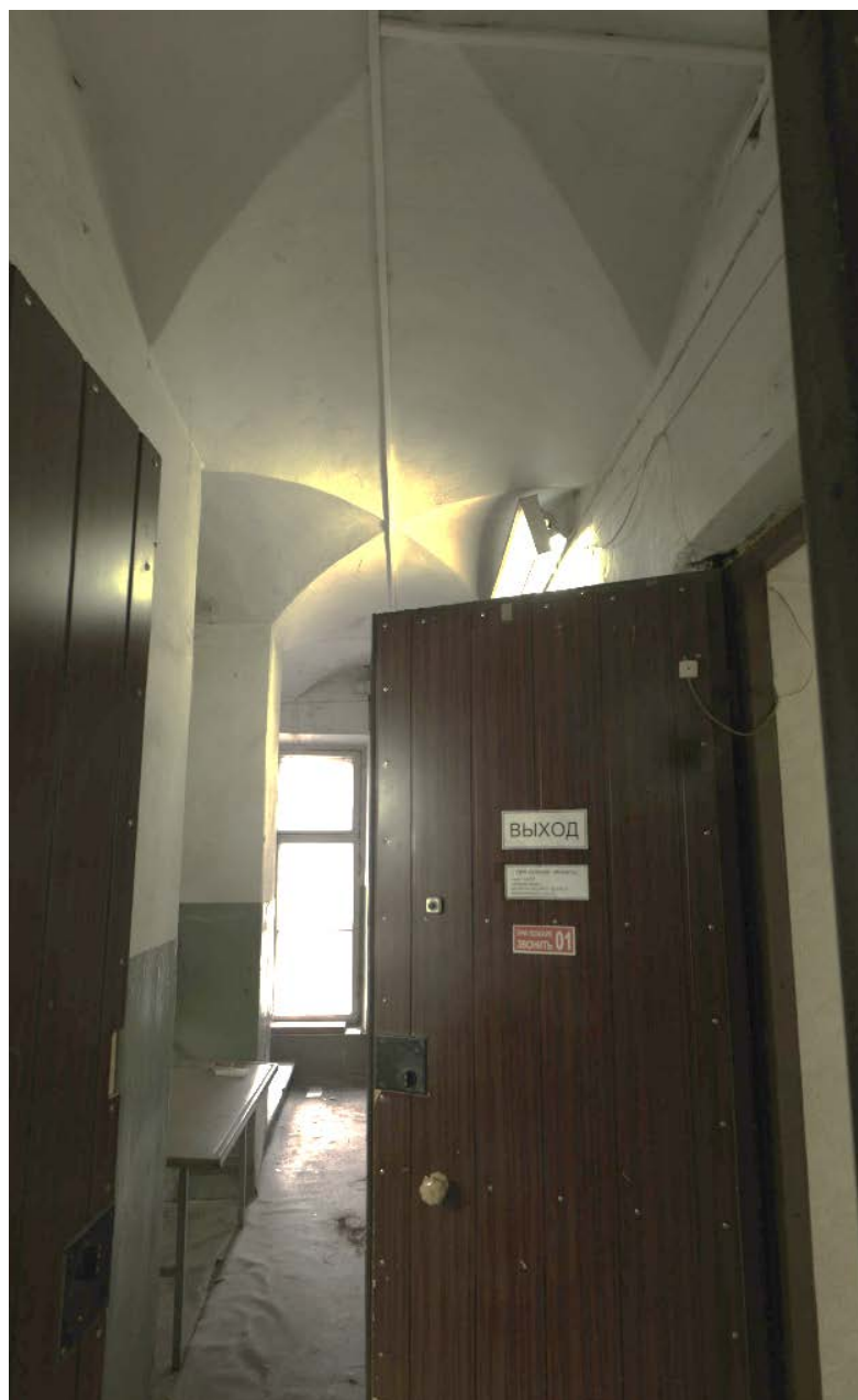
18. Помещение лестничной клетки (пом. №6 (1-Н) в уровне 1-го этажа объекта культурного наследия федерального значения «Флигели (два). Флигель». 31.07.2020.
