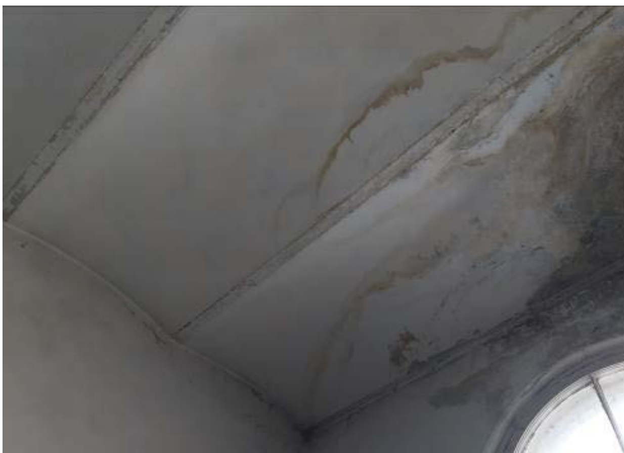
32. Перекрытие лестничной клетки помещения №21 в уровне 2-го этажа объекта культурного наследия федерального значения «Флигели (два). Флигель», расположенного по адресу: г. Санкт-Петербург, ул. Рентгена, д. 1 лит. Б. 31.07.2020.
