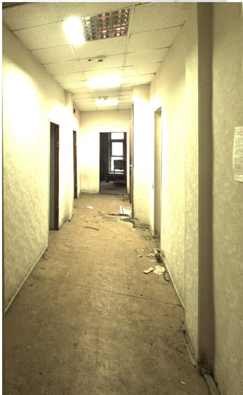
19. Помещение №8 (1-Н) в уровне 1-го этажа объекта культурного наследия федерального значения «Флигели (два). Флигель». 31.07.2020.
