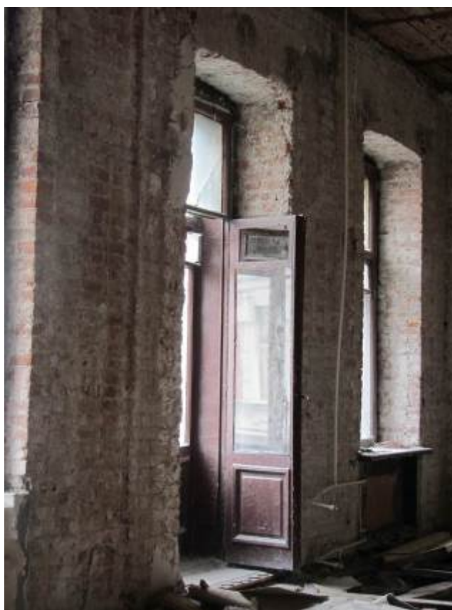
19. ОКН регионального значения «Жилой дом страхового общества “Россия” с садом и оградами» (г. Санкт-Петербург, Моховая ул., 27-29) Помещение квартиры №36
