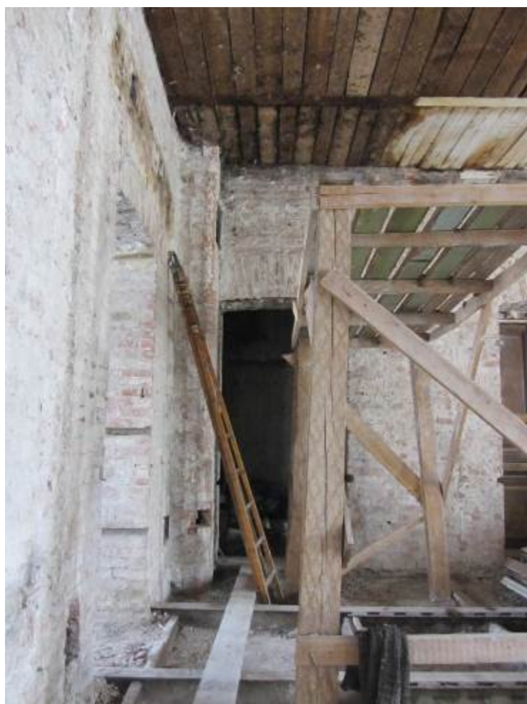
20. ОКН регионального значения «Жилой дом страхового общества “Россия” с садом и оградами» (г. Санкт-Петербург, Моховая ул., 27-29) Помещение квартиры №36
