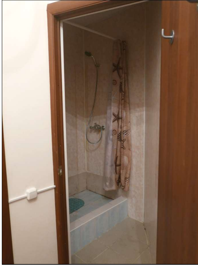
17. Хозяйственное помещение (пом. 9 согласно инвентарному плану 2012 г.). Общий вид на существующее помещение душевой, не зафиксированное инвентарным планом 2012 г.).
