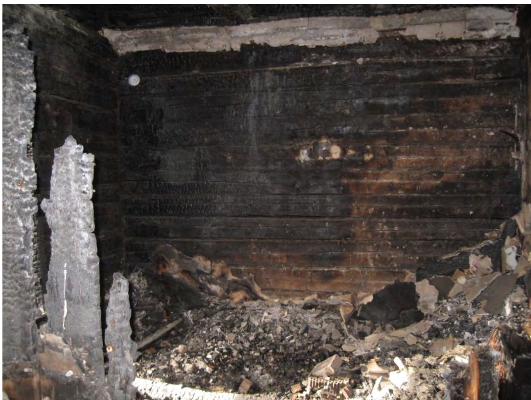
14. ОКН РЗ «Дача Гербель» по адресу: г.Санкт-Петербург, ул. Межозёрная, дом 4, литера А. Вид на помещения здания, повреждённые пожаром. Дата съёмки: 06.04.2016 г.
