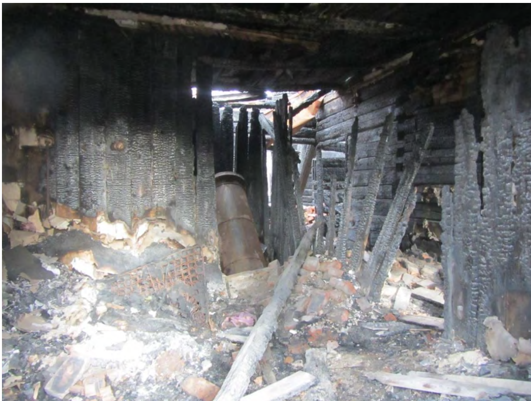
13. ОКН РЗ «Дача Гербель» по адресу: г.Санкт-Петербург, ул. Межозёрная, дом 4, литера А. Вид на помещения здания, повреждённые пожаром. Дата съёмки: 06.04.2016 г.
