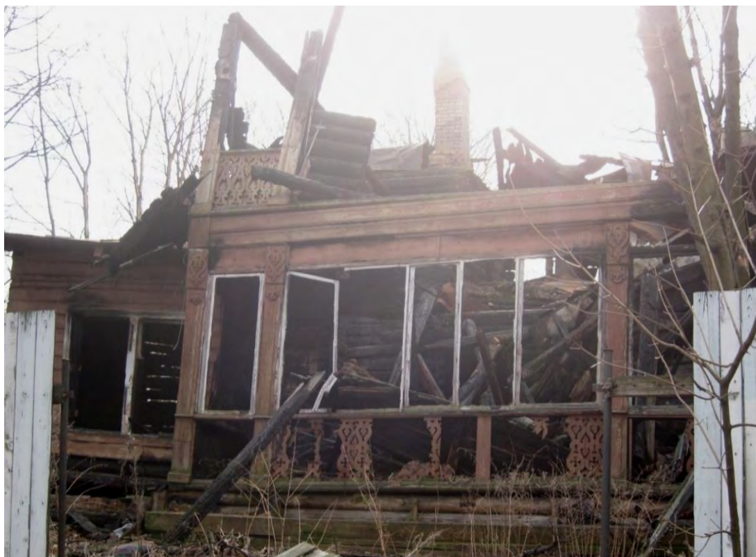
12. ОКН РЗ «Дача Гербель» по адресу: г.Санкт-Петербург, ул. Межозёрная, дом 4, литера А. Восточный фасад. Фрагмент. Дата съёмки: 06.04.2016 г.
