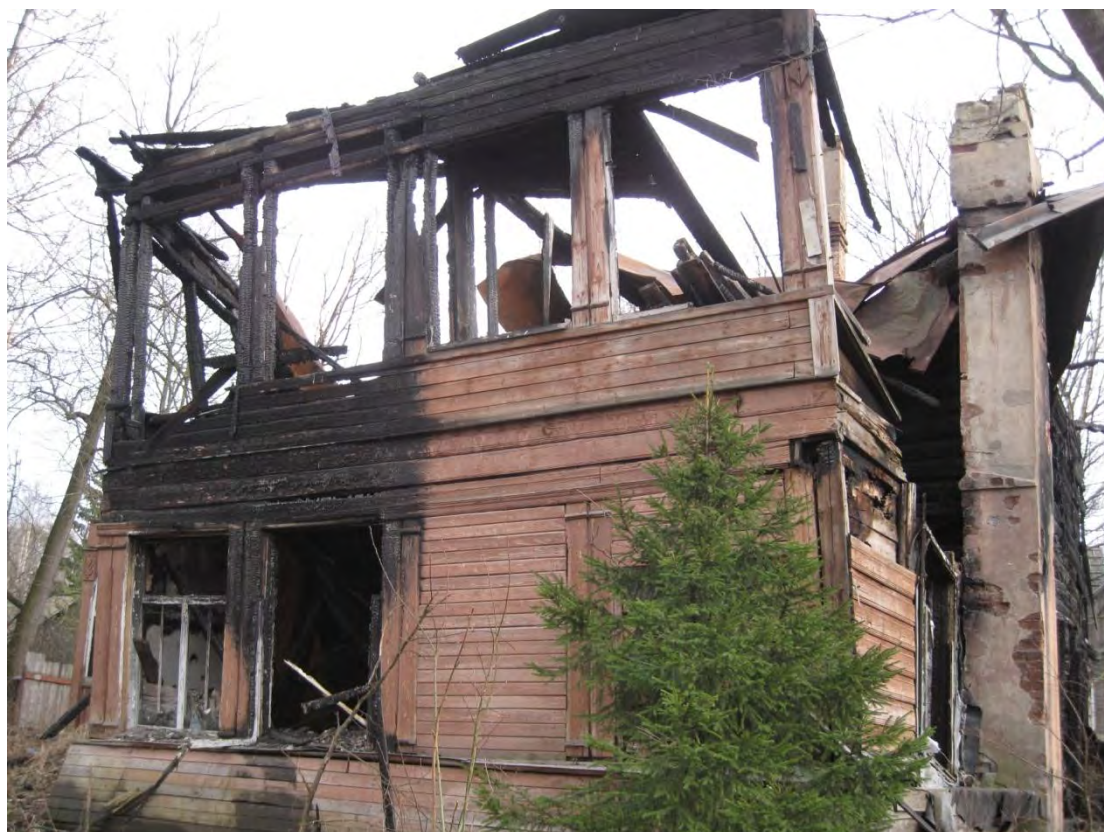
10. ОКН РЗ «Дача Гербель» по адресу: г.Санкт-Петербург, ул. Межозёрная, дом 4, литера А. Северный фасад. Дата съёмки: 06.04.2016 г.
