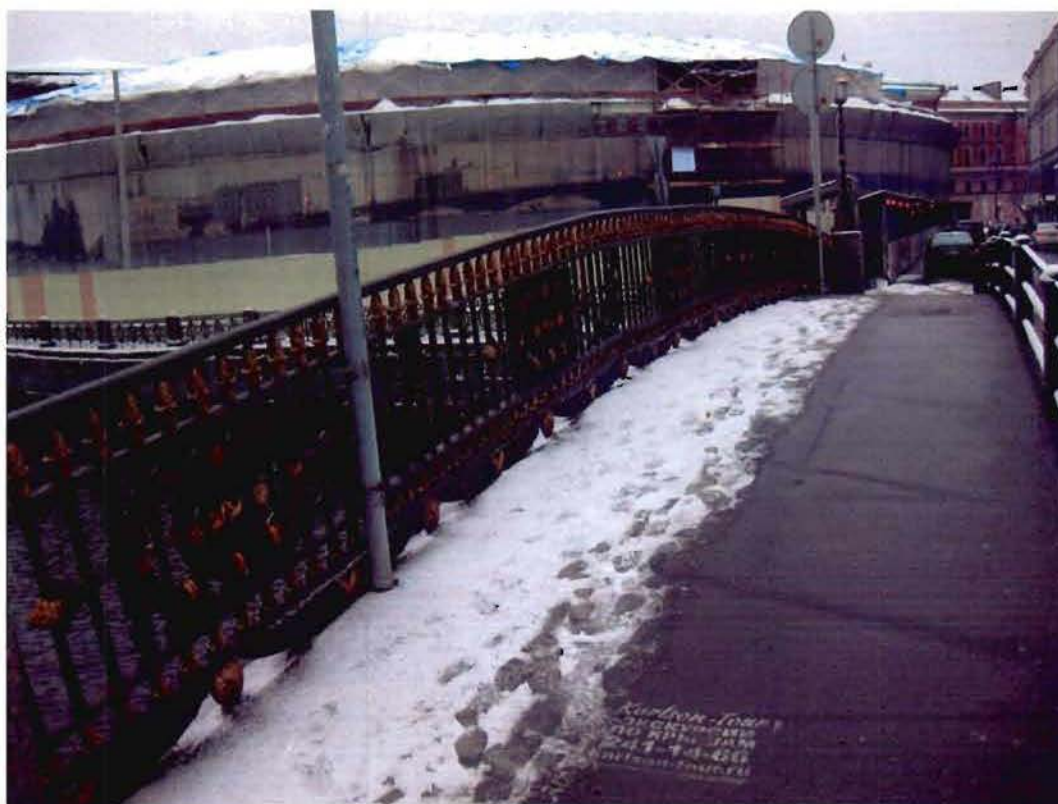
4. Решётка перильного ограждения (утрата красочного слоя и позолоты, коррозия), тротуар со стороны верхового фасада
