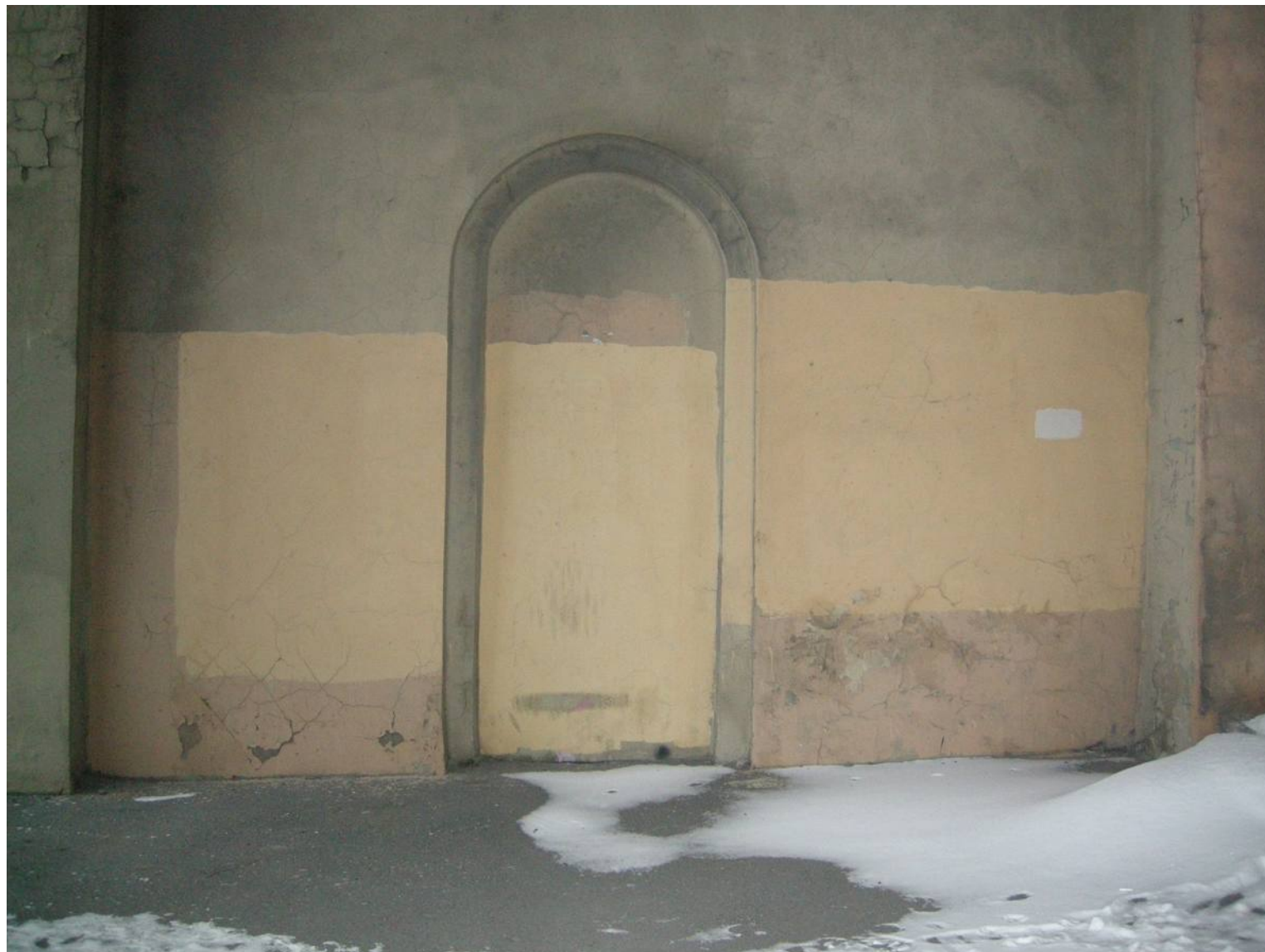
21. Объект культурного наследия регионального значения «Комплекс жилых домов (6 зданий)», расположенный по адресу: Санкт-Петербург, Красногвардейский район, Малоохтинский пр., 86, лит. А Ниша с полуциркульным завершением в стене центрального проезда Съемка: 14 декабря 2020 г.
