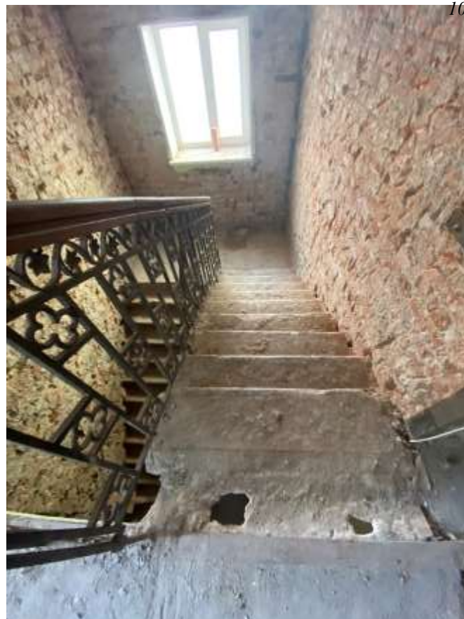
Фото 22. Общее состояние лестничных маршей в уровне 2-го этажа. Вид с юга.
