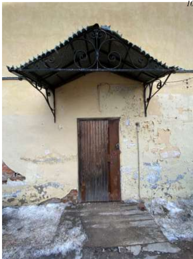
Фото 10. Дверное заполнение и кованый металлический козырек южного дворового фасада флигеля. Вид с юга.
