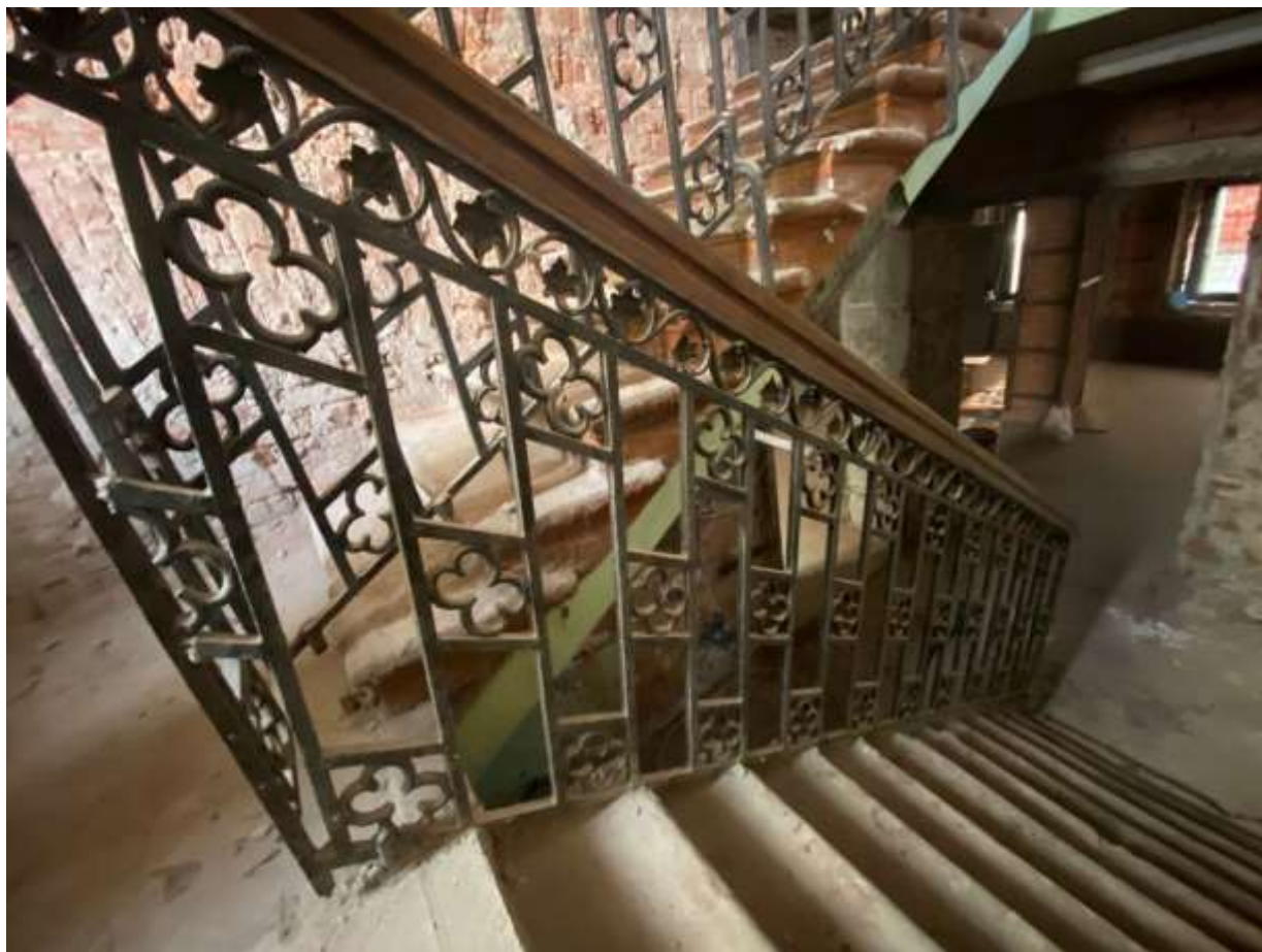
Фото 24. Общее состояние кованного лестничного ограждения. Частичная утрата элементов ограждения. Вид с северо-запада.
