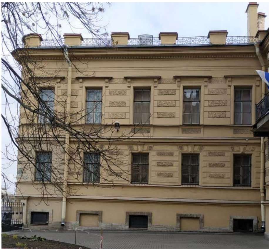
2. Здание Петровского коммерческого училища Санкт-Петербургского купеческого общества (с флигелями, сквером, металлической оградой). Штиглиц М.С. 30.11.2020.
