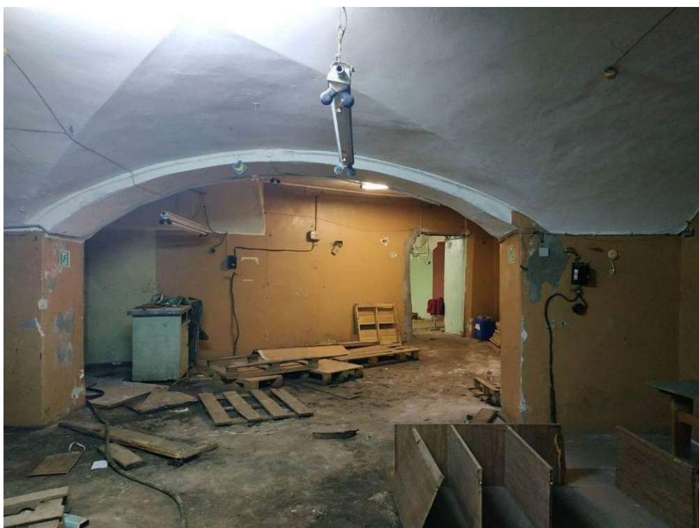
14. Здание Петровского коммерческого училища Санкт-Петербургского купеческого общества (с флигелями, сквером, металлической оградой). Подвал. Штиглиц М.С. 30.11.2020.
