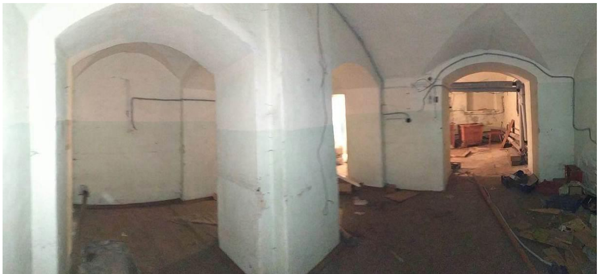
12. Здание Петровского коммерческого училища Санкт-Петербургского купеческого общества (с флигелями, сквером, металлической оградой). Подвал. Штиглиц М.С. 30.11.2020.
