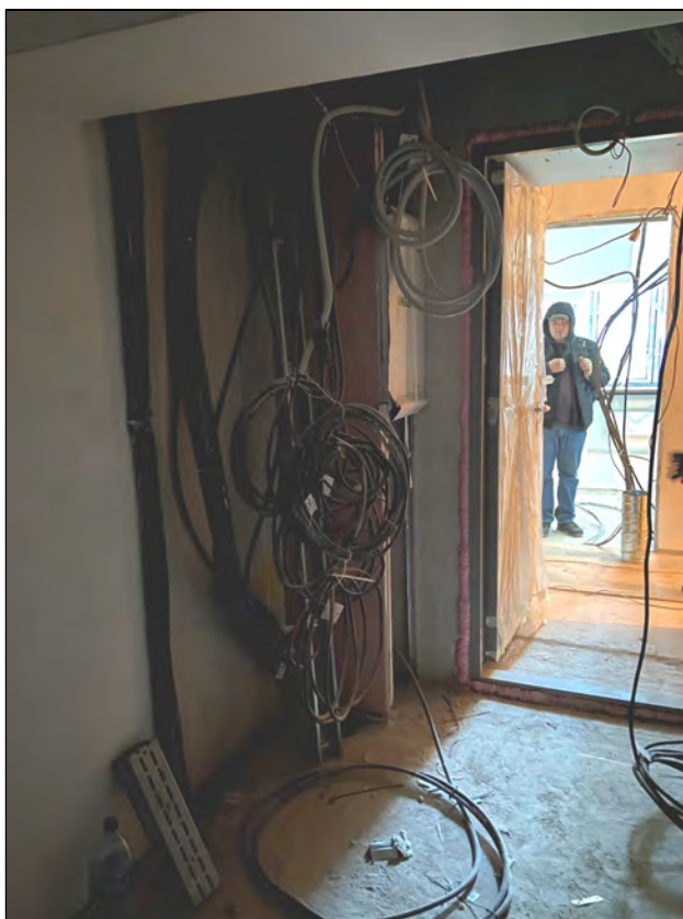
17. Объект культурного наследия «Большой железный ряд или Кожевенная линия». Средний корпус. 2-й этаж, северо-западная часть помещения № 207. Кабели гр.1 и гр. 2. Вид от лифта. 11.11.2020 г.
