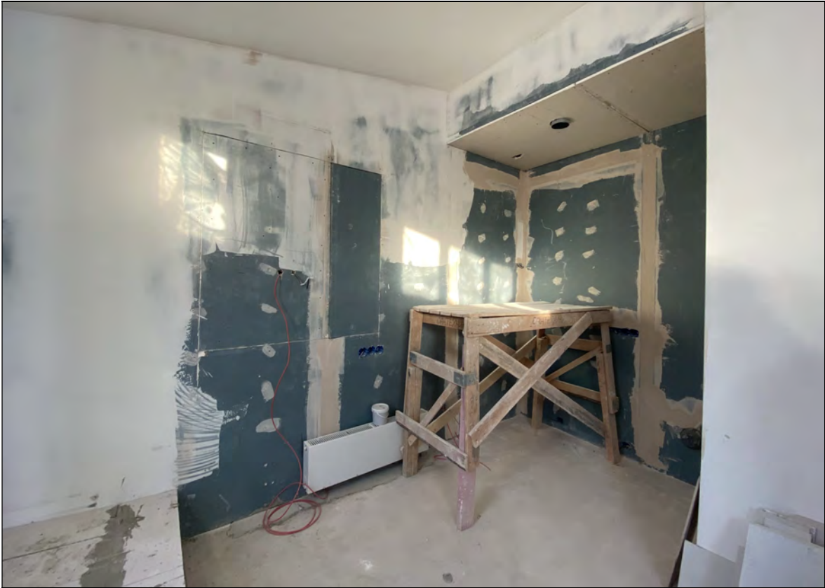
24. Объект культурного наследия «Большой железный ряд или Кожевенная линия». Средний корпус. Мансарда, западная часть помещения № 604. 11.11.2020 г.
