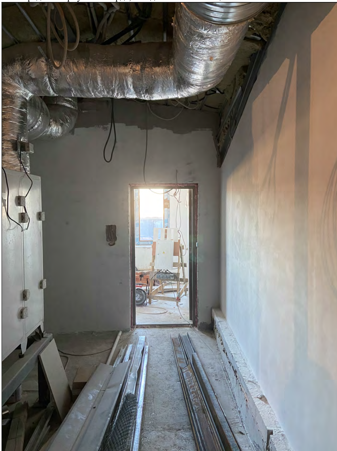
23. Объект культурного наследия «Большой железный ряд или Кожевенная линия». Средний корпус. Мансарда, восточная часть помещения № 610. Выход на лестницу. 11.11.2020 г.
