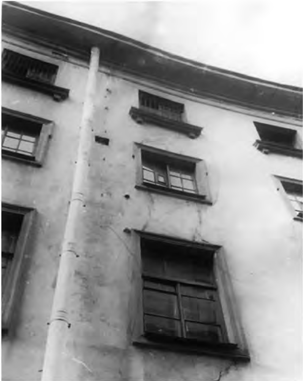
Илл. 37. Малый гостиный двор. Большой железный ряд. Фрагмент фасада со стороны Москательного переуллка. Архив института «Ленжилпроект». 1984 год.
