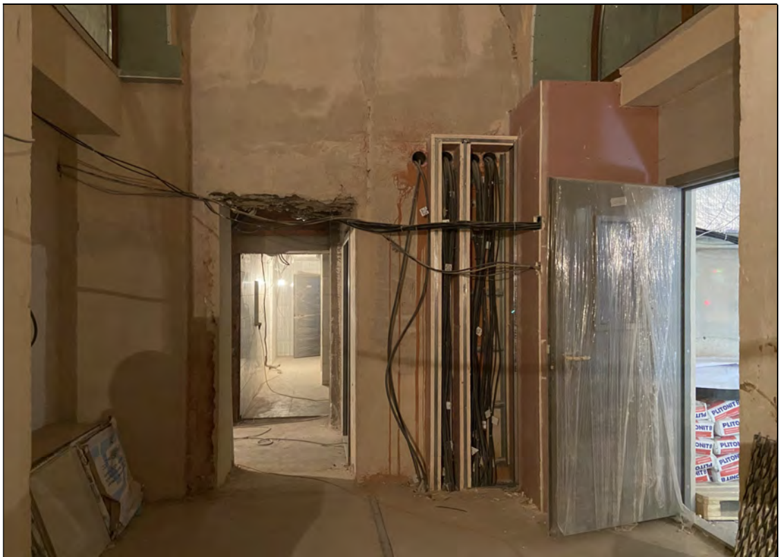
15. Объект культурного наследия «Большой железный ряд или Кожевенная линия». Средний корпус. 1-й этаж, восточная часть помещения № 115. Кабели гр.1 и гр. 2. 11.11.2020 г.
