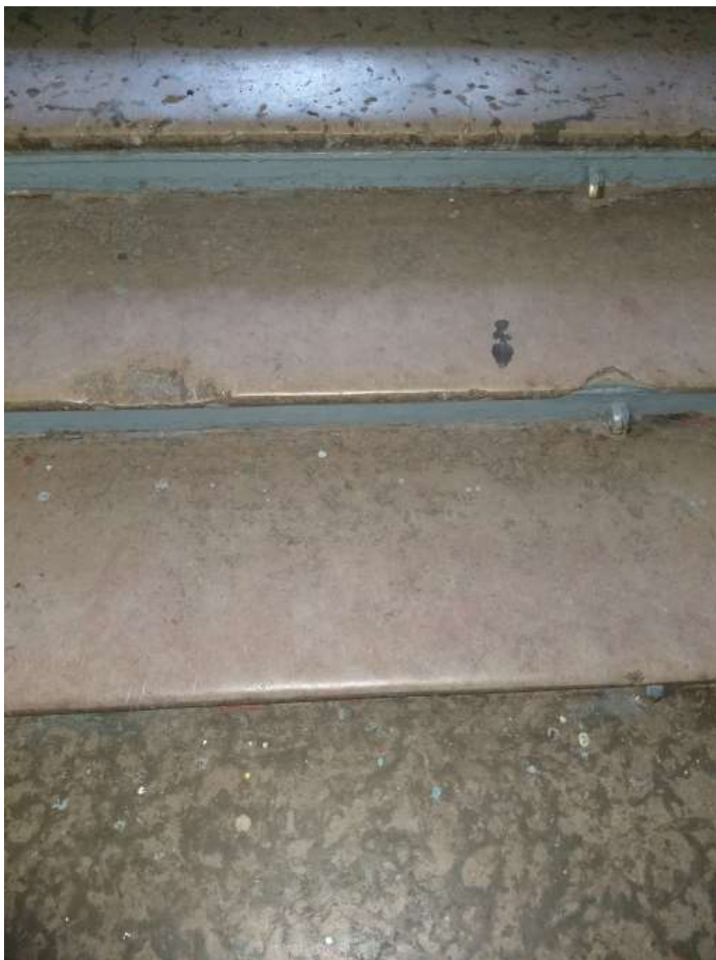
ФФ. 37 Общее состояние ступеней. 02.05.2020.
