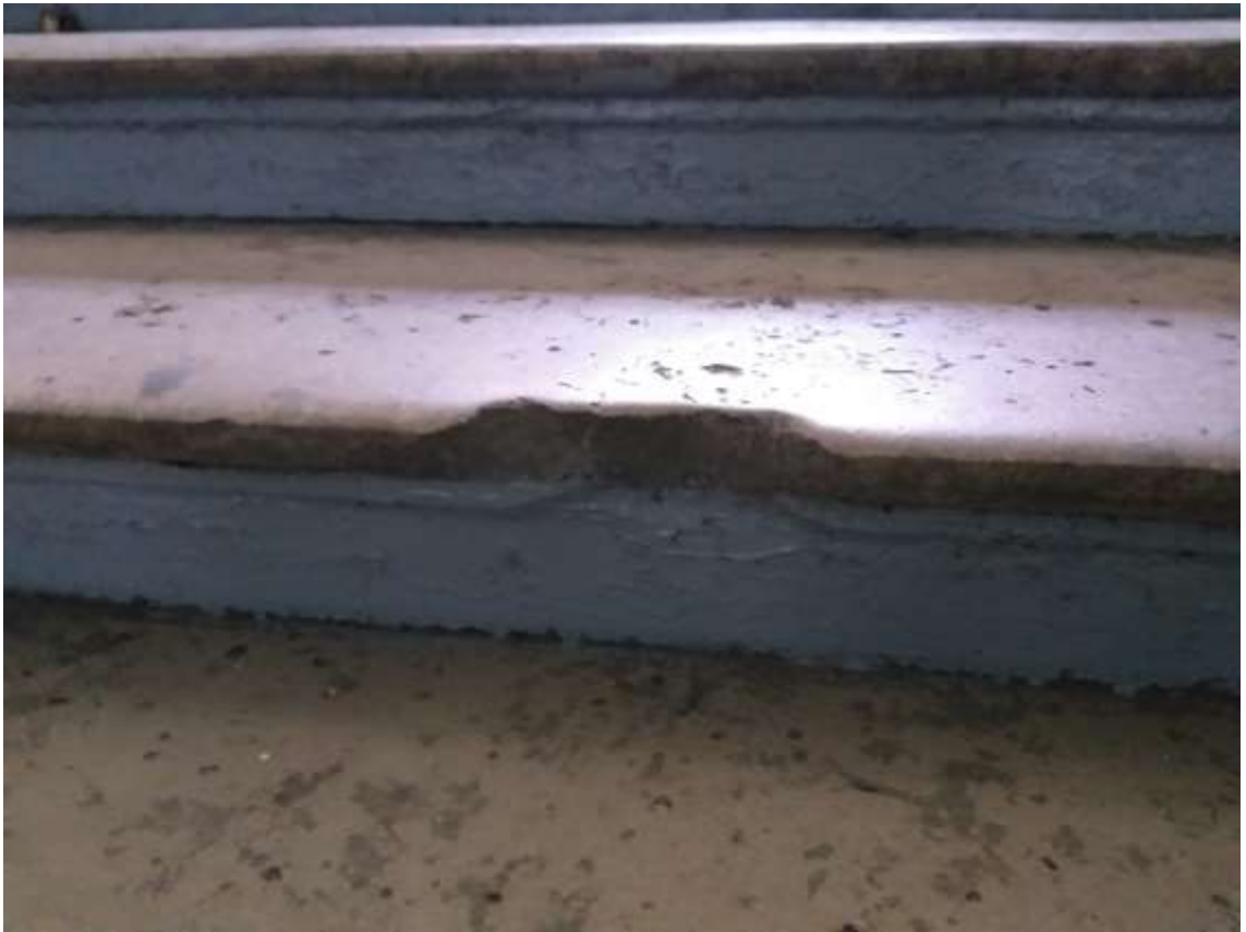
ФФ. 22 Состояние лестничных ступеней 02.05.2020.
