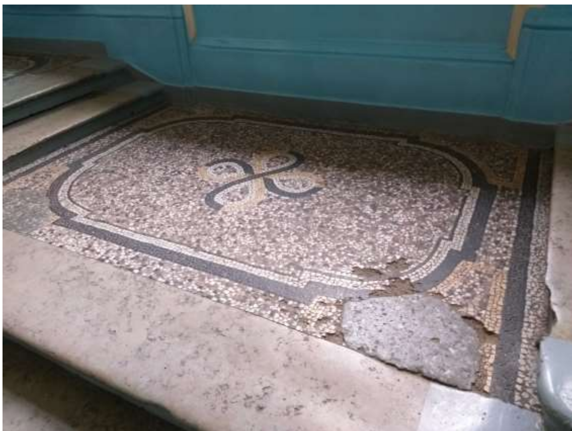
ФФ. 24 Состояние напольного мозаичного покрытия в уровне первой межэтажной площадки 02.05.2020.
