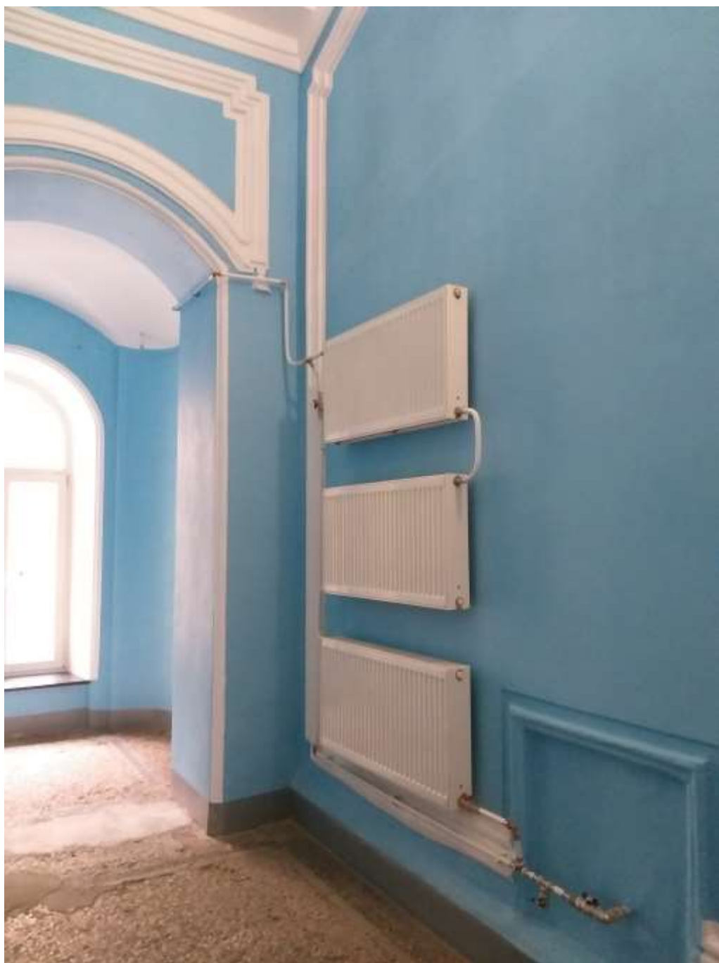
ФФ. 18 Стены коридора в уровне первого этажа справа от лестницы. Система отопления помещения 02.05.2020
