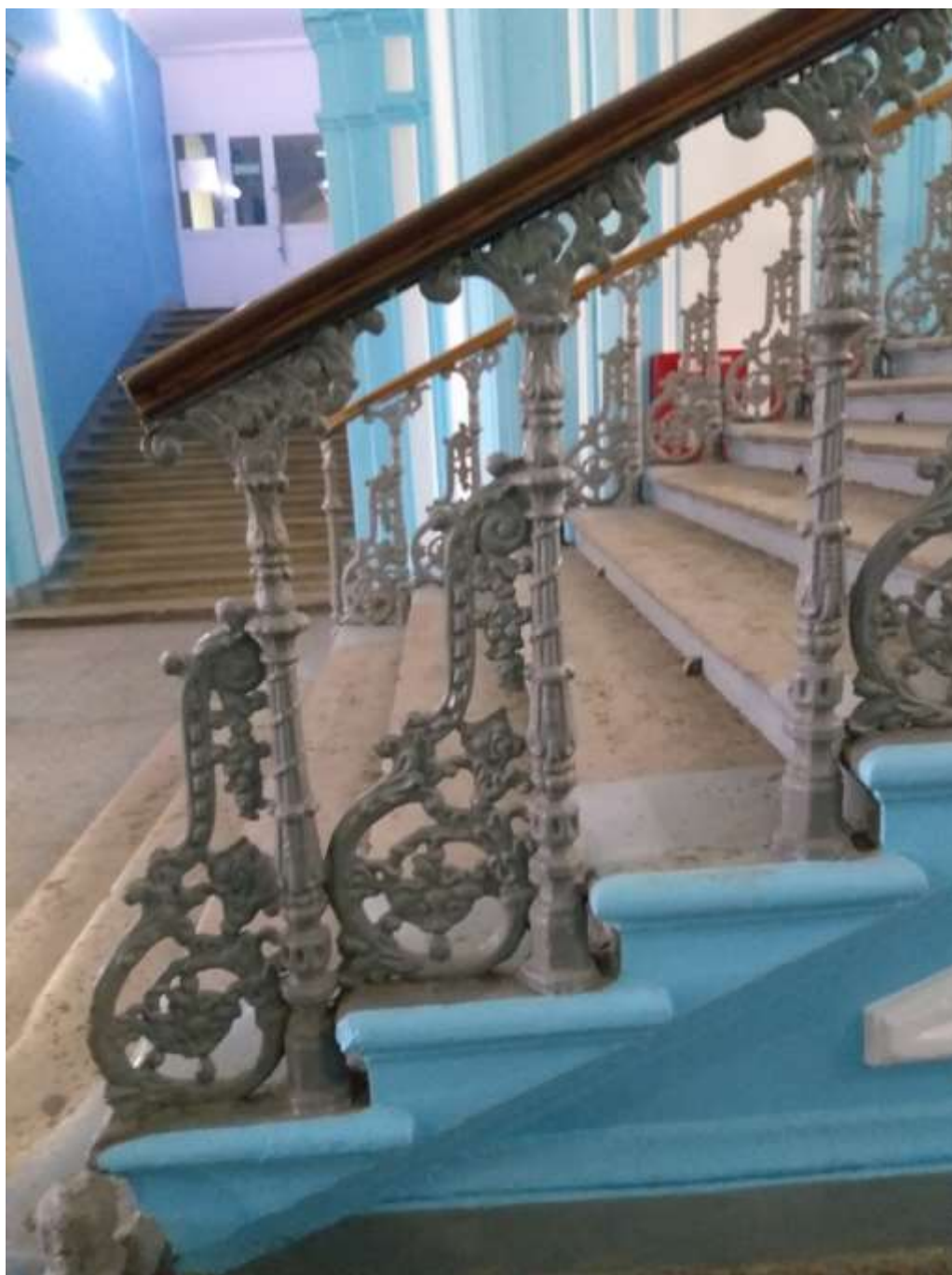
ФФ. 57 Ограждение лестницы. Утраты 02.05.2020.
