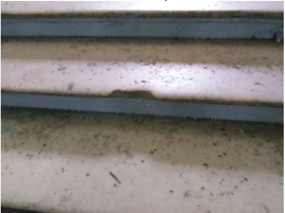
ФФ. 23 Состояние лестничных ступеней 02.05.2020.
