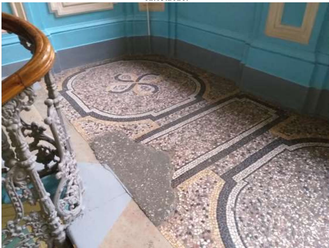
ФФ. 39 Состояние напольного мозаичного покрытия межэтажной площадки между первым и вторым этажами. Вид с лестничного марша по направлению подъема налево. 02.05.2020.
