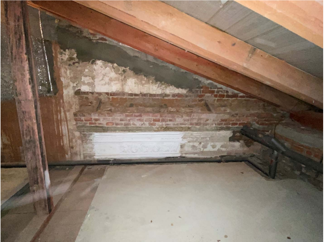
Фото №105. Чердак, сохранившийся элемент карниза.
