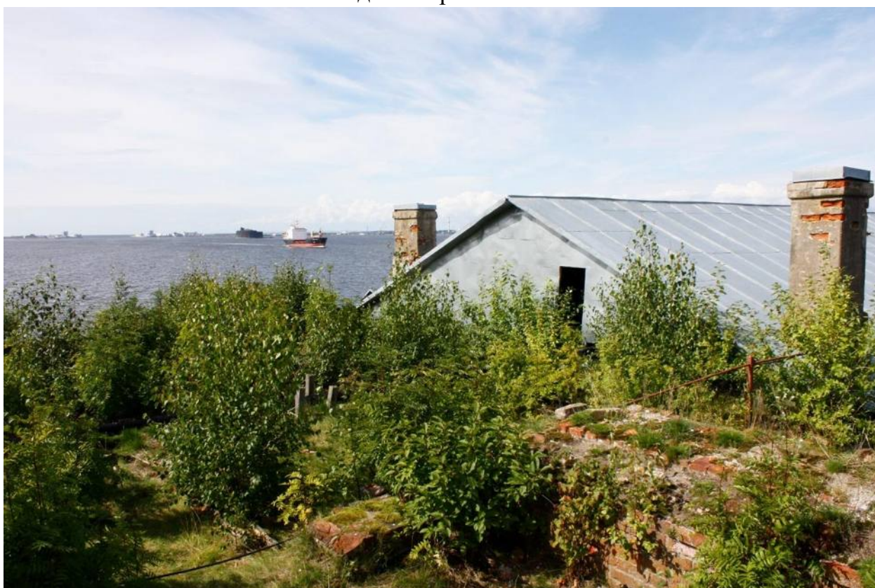
Фото 55. Перекрытие центральной части основного объема. Крыша утрачена. Вид с юга
