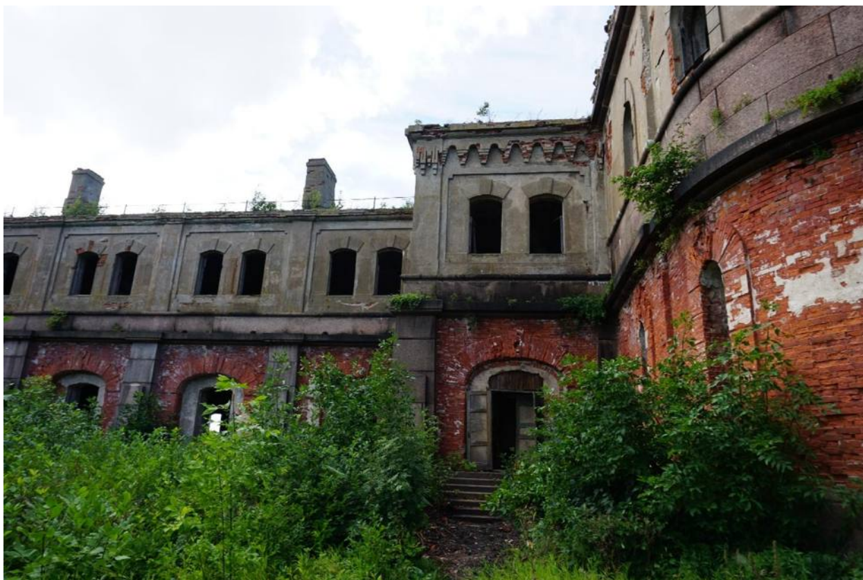
Фото 14. Юго-восточный фасад южной части основного объема. Вход в здание. Вид с востока
