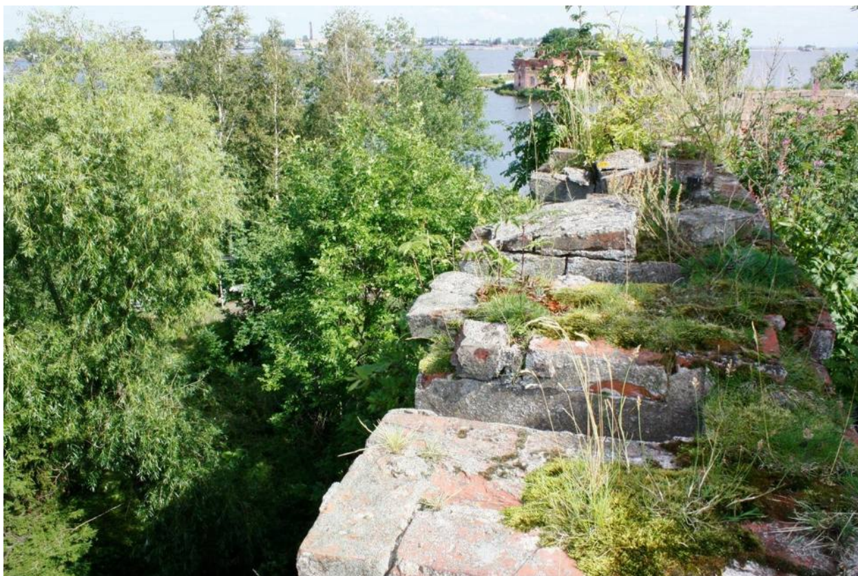
Фото 56. Перекрытие центральной части основного объема и центрального ризалита. Крыша утрачена. Вид с северо-запада
