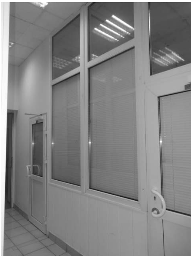
61. Коридор. Западный фасад. Вид на юг. Объект культурного наследия федерального значения «Дом, где в первой половине XIX в. размещалась Российско-Американская компания. Здесь в 1820-х гг. жили декабристы Бестужев-Марлинский А.А. и Рылеев К.Ф.», расположенный по адресу: Санкт-Петербург, Адмиралтейский район, набережная реки Мойки, дом 72, литера А. Дата дополнительной съемки: 08.07.2019.
