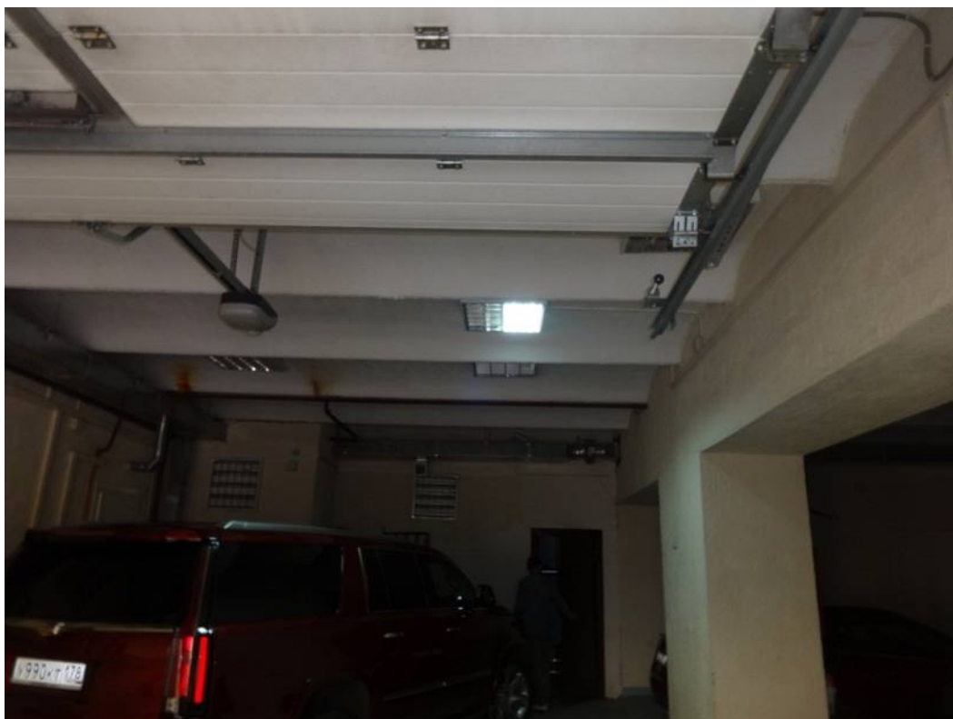
5. Помещение гаража. Южный фасад. Объект культурного наследия федерального значения «Дом, где в первой половине XIX в. размещалась Российско-Американская компания. Здесь в 1820-х гг. жили декабристы Бестужев-Марлинский А.А. и Рылеев К.Ф.», расположенный по адресу: Санкт-Петербург, Адмиралтейский район, набережная реки Мойки, дом 72, литера А. Дата дополнительной съемки: 08.07.2019.
