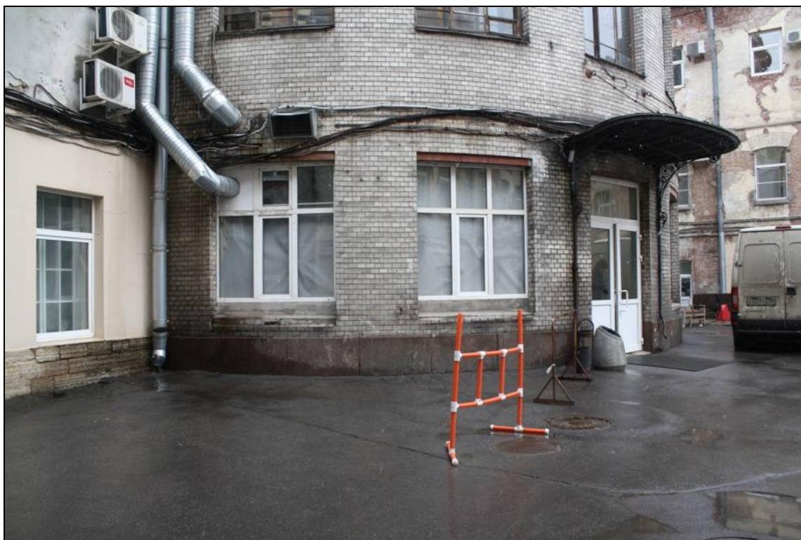
8. Окна ПВХ первого этажа. Объект культурного наследия федерального значения «Дом, где в первой половине XIX в. размещалась Российско-Американская компания. Здесь в 1820-х гг. жили декабристы Бестужев-Марлинский А.А. и Рылеев К.Ф.», расположенный по адресу: Санкт-Петербург, Адмиралтейский район, набережная реки Мойки, дом 72, литера А. Дата съемки: 21.06.2019.
