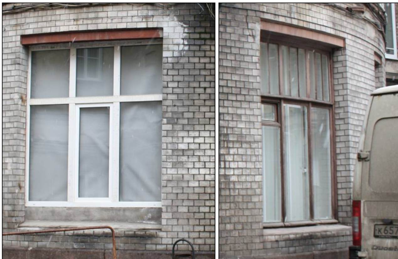
13. Оконные заполнения первого этажа. Слева – окно ПВХ современное, справа – историческое. Объект культурного наследия федерального значения «Дом, где в первой половине XIX в. размещалась Российско-Американская компания. Здесь в 1820-х гг. жили декабристы Бестужев-Марлинский А.А. и Рылеев К.Ф.», расположенный по адресу: Санкт-Петербург, Адмиралтейский район, набережная реки Мойки, дом 72, литера А. Дата съемки: 21.06.2019.
