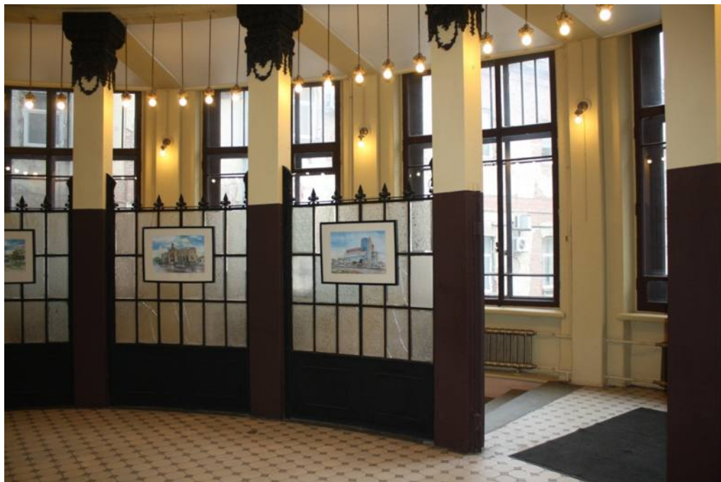
67. Помещение 1-Н (бывший «Операционный зал»). Перегородки между пилонами, с остеклением бесцветным офактуренным стеклом с рисунком «мороз». Объект культурного наследия федерального значения «Дом, где в первой половине XIX в. размещалась Российско-Американская компания. Здесь в 1820-х гг. жили декабристы Бестужев-Марлинский А.А. и Рылеев К.Ф.», расположенный по адресу: Санкт-Петербург, Адмиралтейский район, набережная реки Мойки, дом 72, литера А. Дата дополнительной съемки: 08.07.2019.
