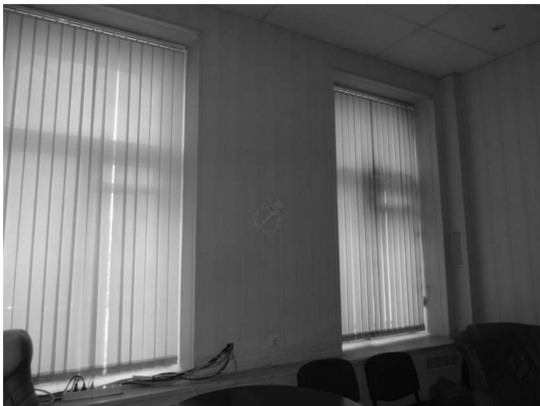
53. Офисное помещение. Вид на север. Объект культурного наследия федерального значения «Дом, где в первой половине XIX в. размещалась Российско-Американская компания. Здесь в 1820-х гг. жили декабристы Бестужев-Марлинский А.А. и Рылеев К.Ф.», расположенный по адресу: Санкт-Петербург, Адмиралтейский район, набережная реки Мойки, дом 72, литера А. Дата дополнительной съемки: 08.07.2019.
