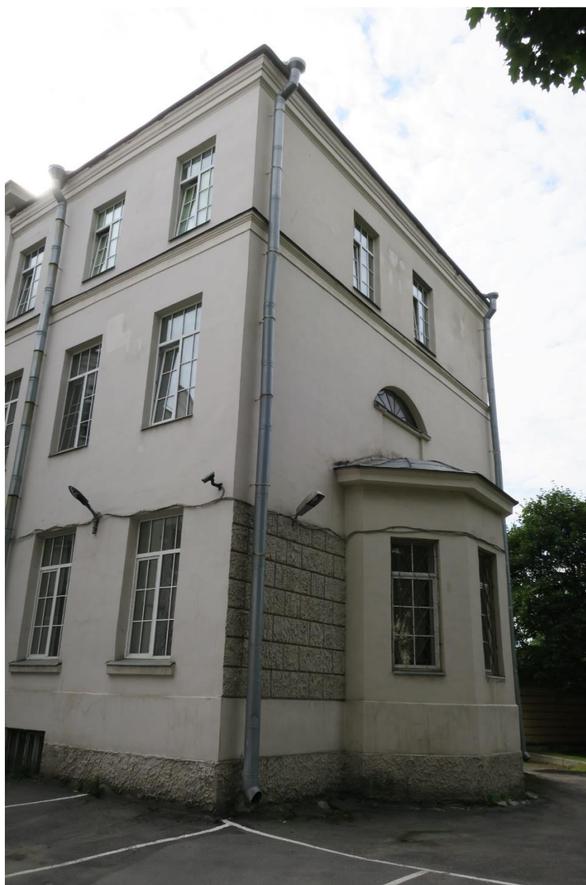
8. Северо-восточный торцевой фасад объекта культурного наследия регионального значения «Противоалкогольный институт» (Главное здание)», расположенного по адресу: г. Санкт-Петербург, ул. Бехтерева д. 3, Лит. А. 26.07.2018
